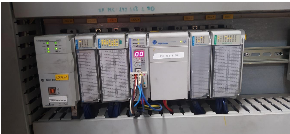
Ilustración 66: PLC Allen Bradley L7
