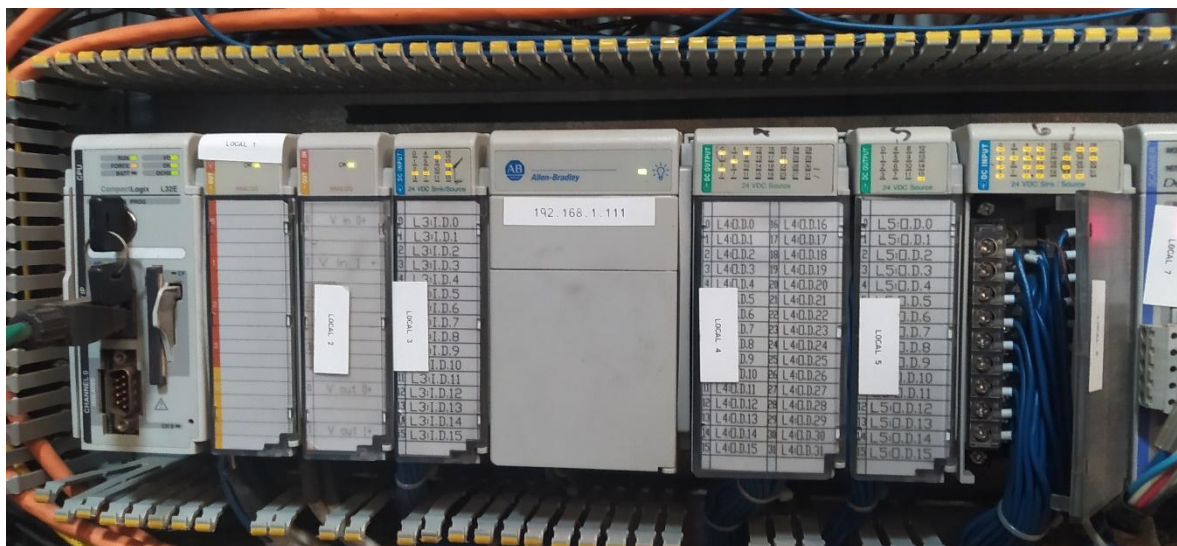
Ilustración 70: PLC Allen Bradley L5
