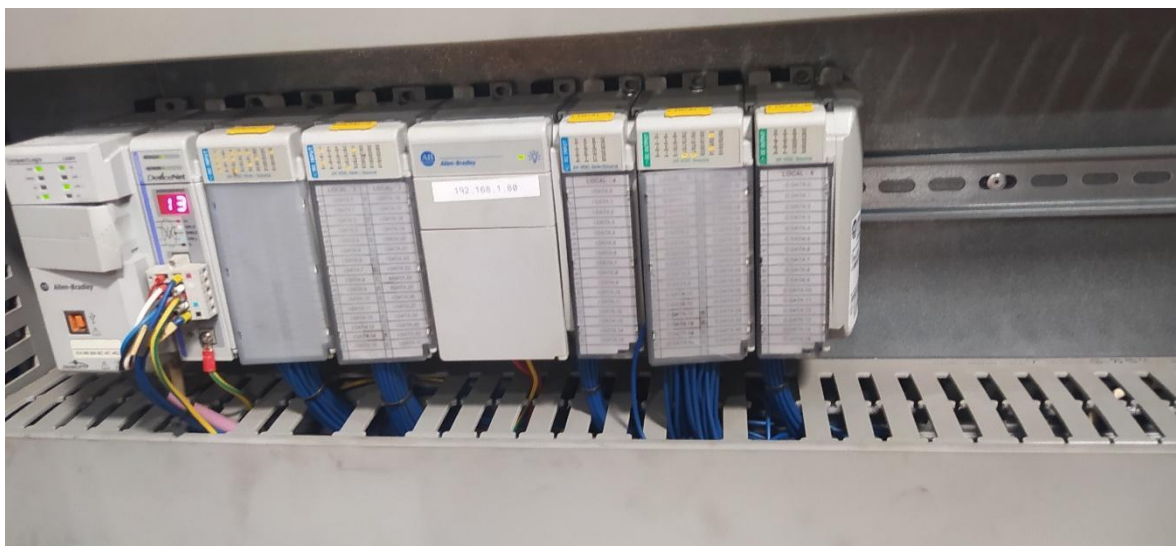
Ilustración 65: PLC Allen Bradley L2
