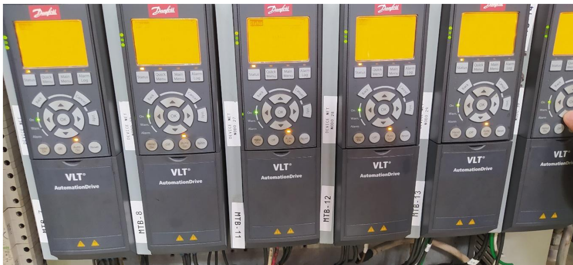
Ilustración 69: Variadores de Frecuencia L3
