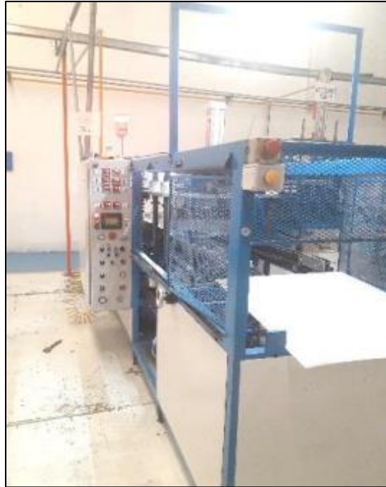
Figura 3.22. Tablero de control de temperaturas.
