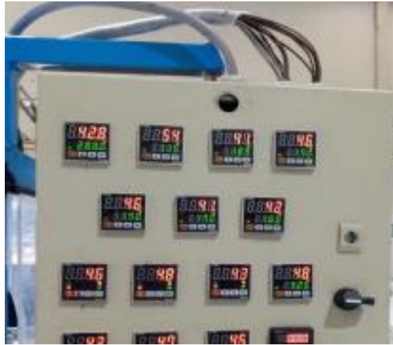
Figura 3.56. Gabinete de temperaturas.
