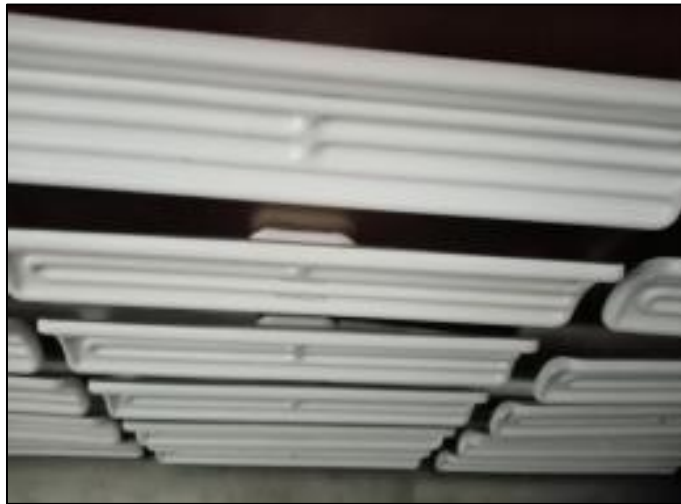
Figura 5.1. Resistencias colocadas en el horno.
