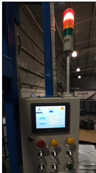
Figura 5.17. Semáforo con paro de emergencia.
