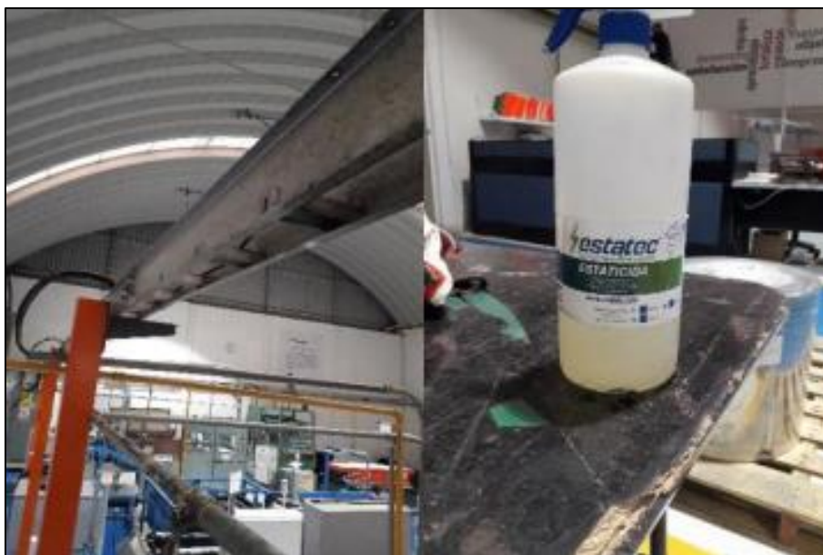
Figura 3.13. Canaleta y desengrasante.
