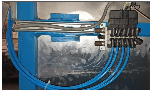
Figura 3.43. Conexiones eléctricas y neumáticas en bloque de válvulas.
