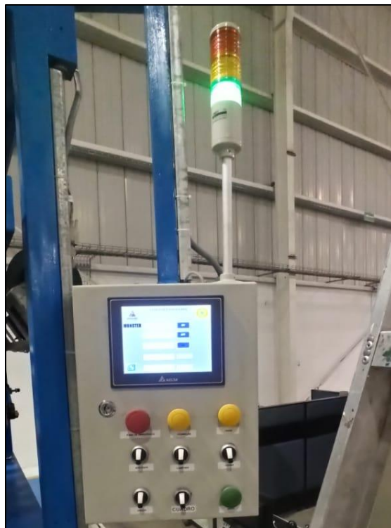
Figura 5.15. Semáforo en modo automático.
