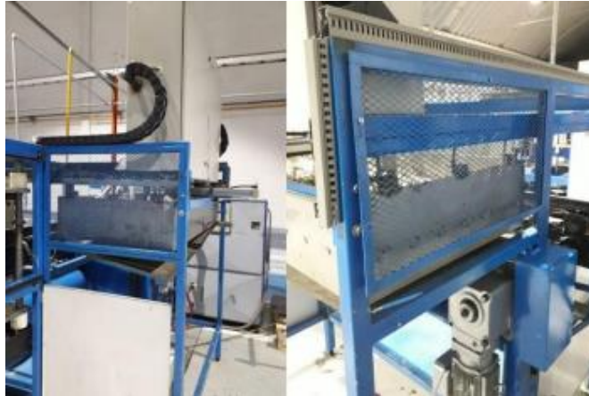
Figura 3.57. Guardas de seguridad.
