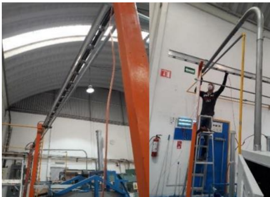
Figura 3.16. Cableado de tierra física.
