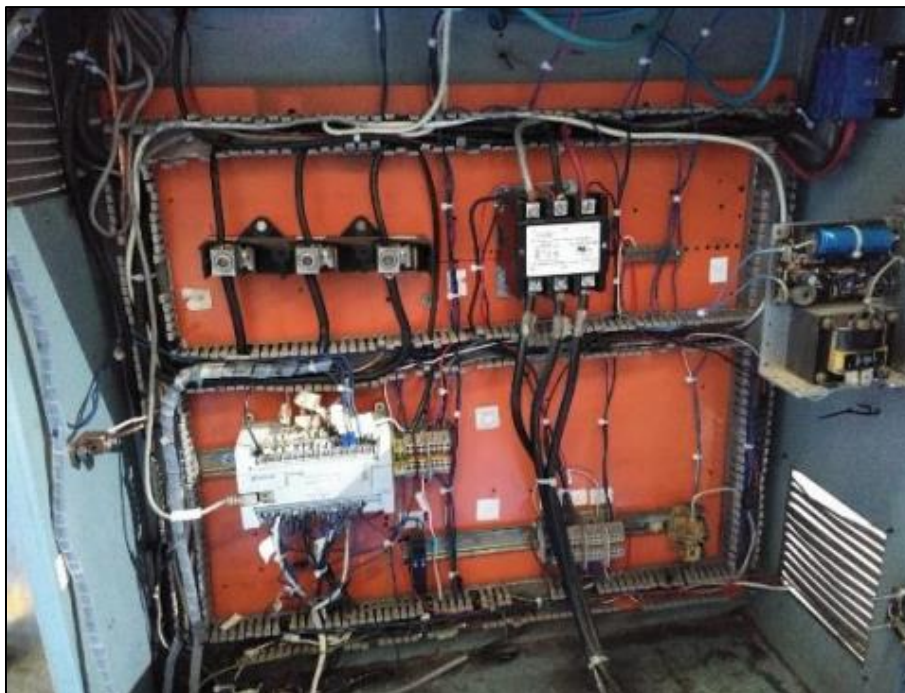
Figura 3.25. Cableado ajustado a la canaleta.
