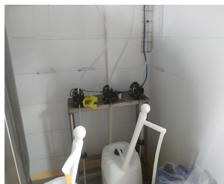
(b) Bombas de dosificación de los químicos
