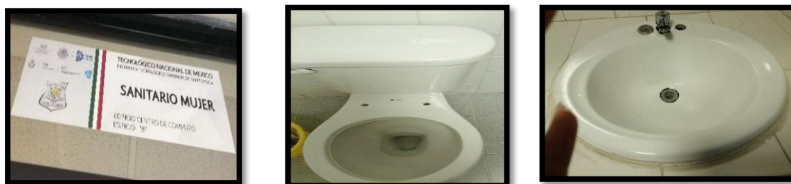
Foto 1. Imágenes de las condiciones de los sanitarios de las mujeres.
