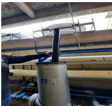
Figura 27 Extracción de filtros pulidores (Elaboración propia).
