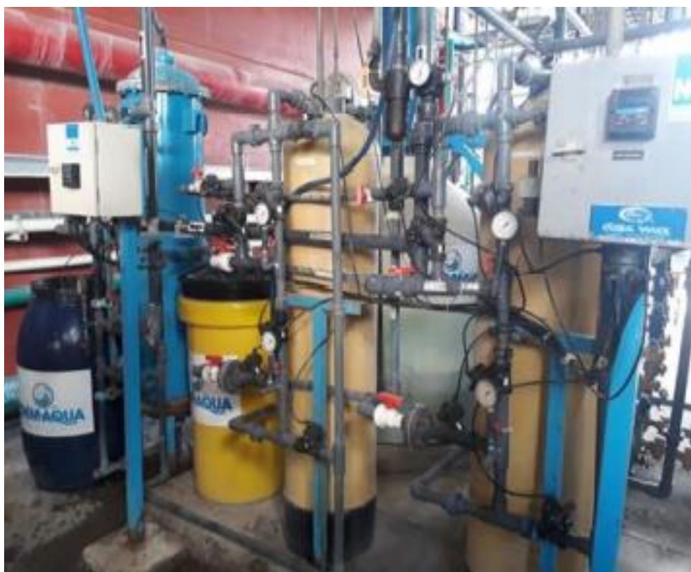
Figura 56 Módulo de suavizadores de planta potabilizadora (Elaboración propia).
