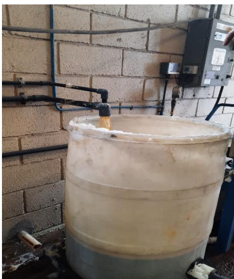
Figura 45 Agua de retrolavado (Elaboración propia).
