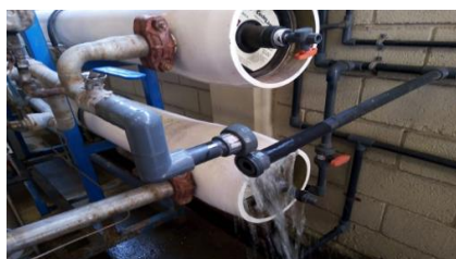
Figura 49 Agua estancada de las membranas (Elaboración propia).
