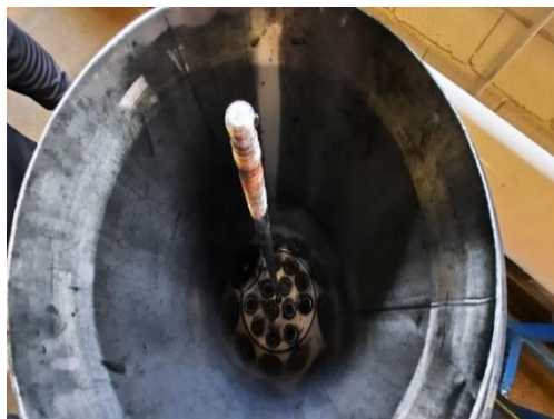
Figura 28 Interior del tanque pulidor (Elaboración propia).
