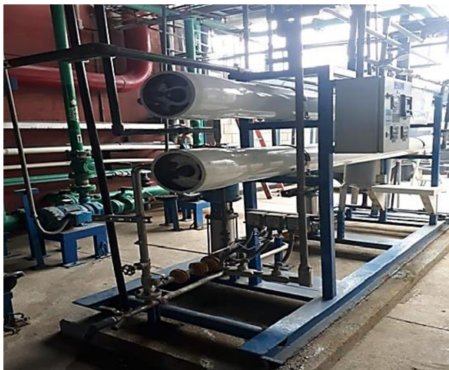
Figura 19 módulo de osmosis 1 (Elaboración propia).
