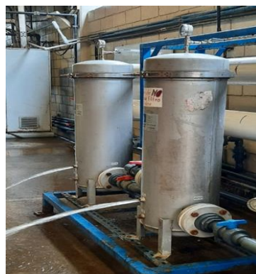
Figura 24 salida del agua acumulada de los filtros (Elaboración propia).
