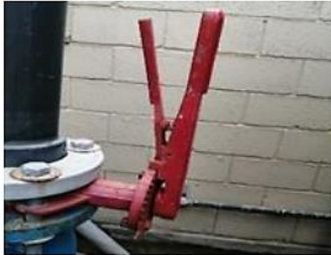
Figura 14 válvula de descarga de bomba de retrolavado (Elaboración propia).
