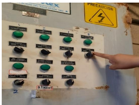
Figura 35 Módulo de operación de osmosis (Elaboración propia).
