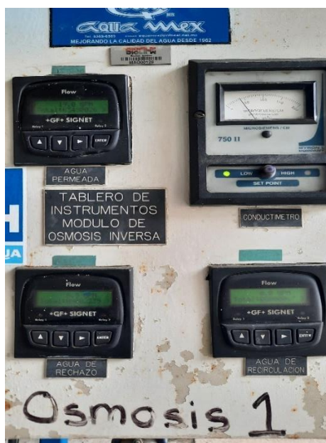
Figura 46 Módulo de osmosis (Elaboración propia).
