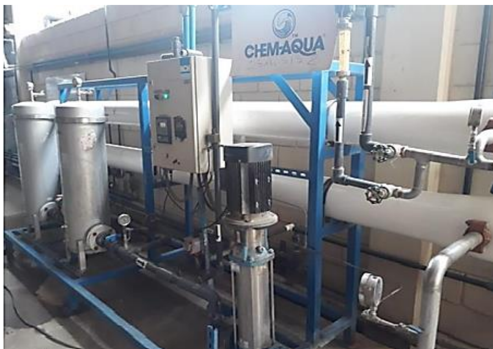
Figura 20 Módulo de osmosis 2 (Elaboración propia).
