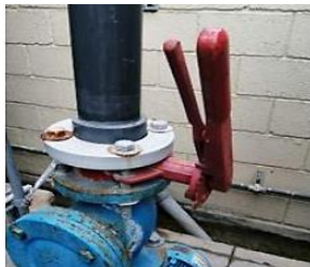
Figura 7 válvula de descarga de bomba de retrolavado (Elaboración propia).
