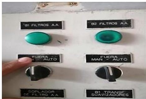
Figura 6 selector de paro y arranque (Elaboración propia).
