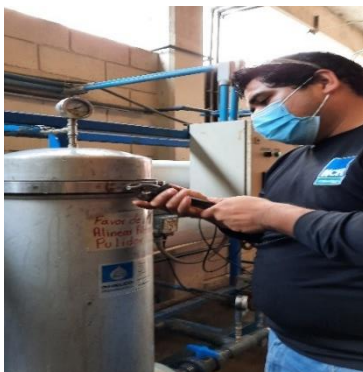
Figura 25 Tornillos del tanque pulidor (Elaboración propia).
