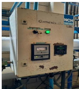
Figura 33 Módulo de Osmosis inversa (Elaboración propia).
