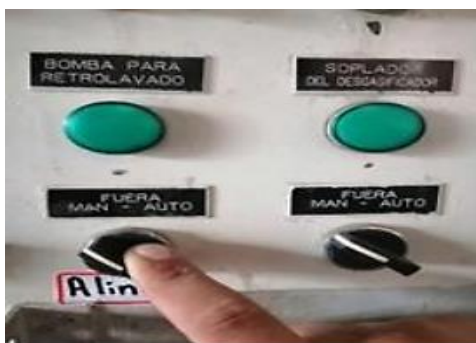
Figura 13 selector de paro y arranque de bomba (Elaboración propia).
