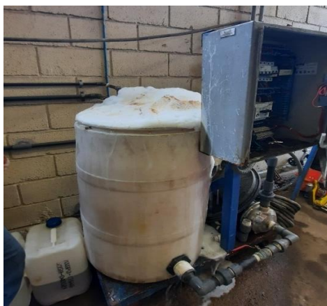
Figura 42 Tanque CIP (Elaboración propia).
