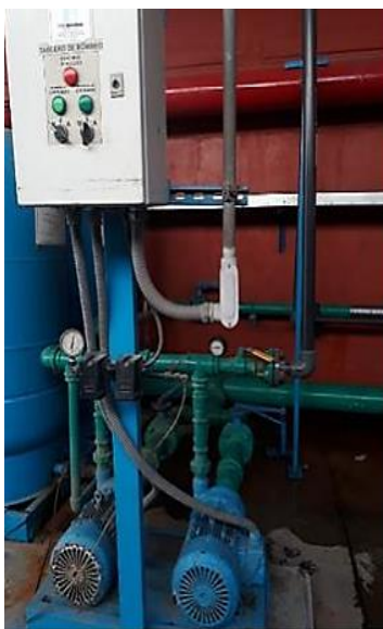
Figura 15 Bombas de alimentación (Elaboración propia).
