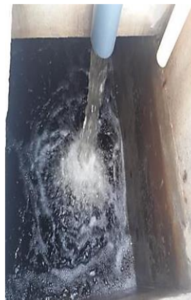
Figura 17 Cisterna de agua (Elaboración propia).
