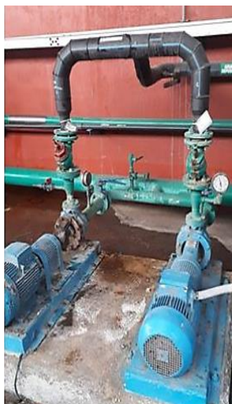
Figura 16 Bombas de torre de enfriamiento (Elaboración propia).
