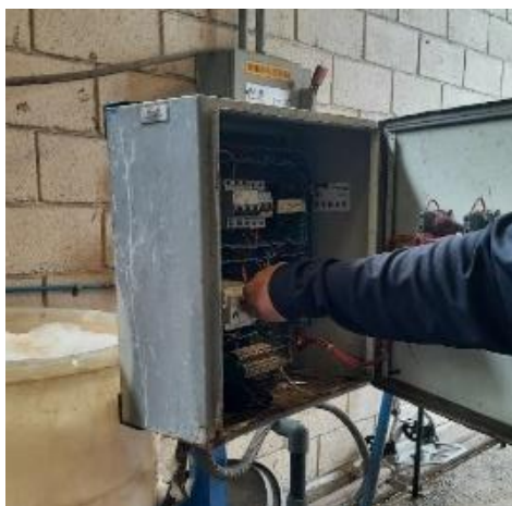
Figura 43 Interruptor de encendido y apagado de bomba (Elaboración propia).
