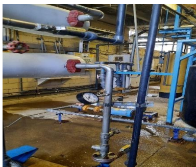
Figura 40 Válvulas de entrada y salida de producto (Elaboración propia).
