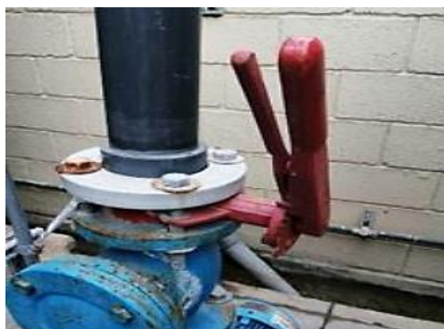
Figura 11 válvula de bomba de retrolavado al 50% (Elaboración propia).
