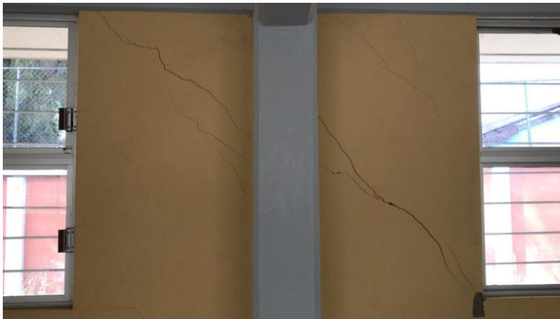
Figura 19. Daños ocasionados en uno de los edificios de la Escuela “Ignacio Allende”, ubicada en Ciudad Nezahualcóyotl, Municipio de Nezahualcóyotl, por sismo del 19 de septiembre de 2017.
