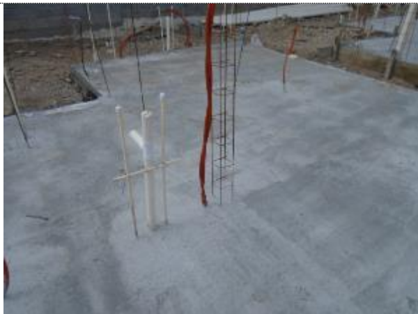
No se apreciaron segregaciones u oquedades.
