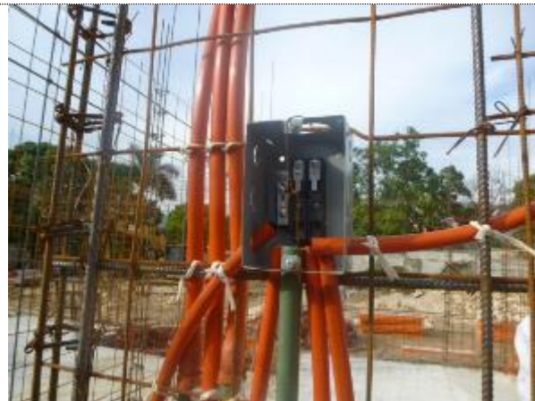
Instalación eléctrica se realiza con poliducto naranja conforme a especificaciones de las instalaciones.
