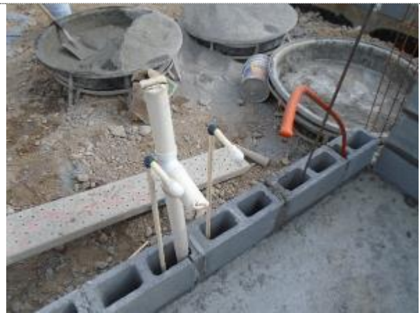
Podemos apreciar que las instalaciones van ocultas en muros y mismas que se realizan bajo especificaciones.
