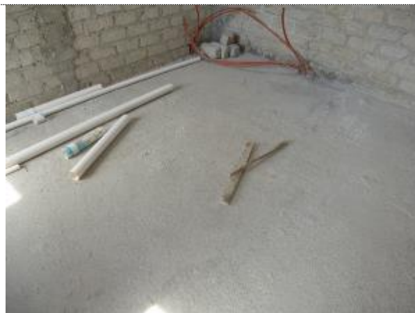
No se apreciaron oquedades o segregaciones en las cimentaciones.
