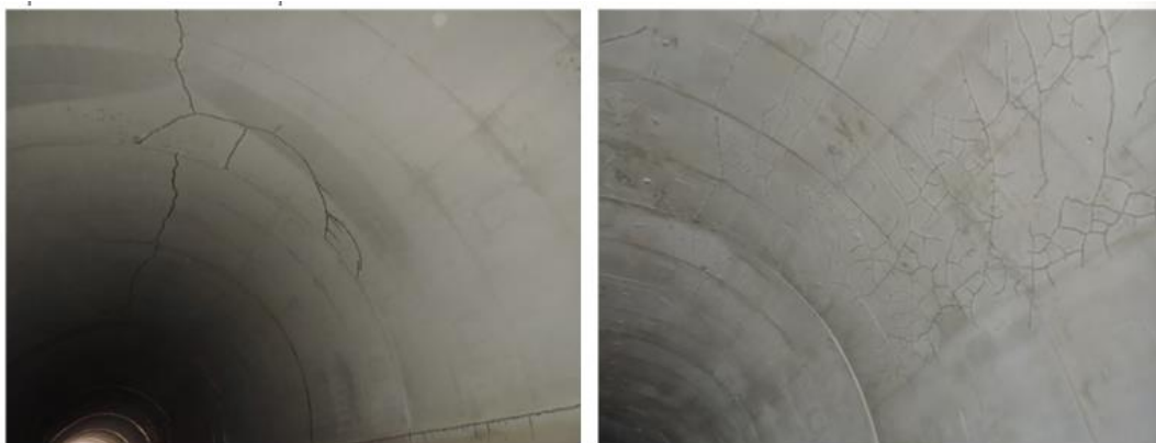
Figura 11.15. Presencia de fisuras, revestimiento concreto simple.
