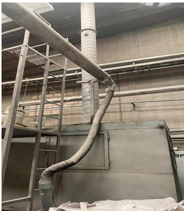
Imagen 7 Chimenea 1 ,Sistema de extraccion de PVC
