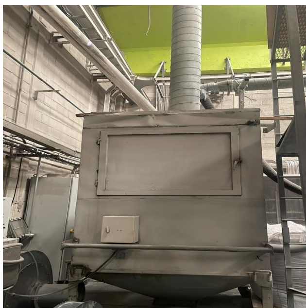
Imagen 8 Chimenea 2 , Sistema de extraccion de PVC
