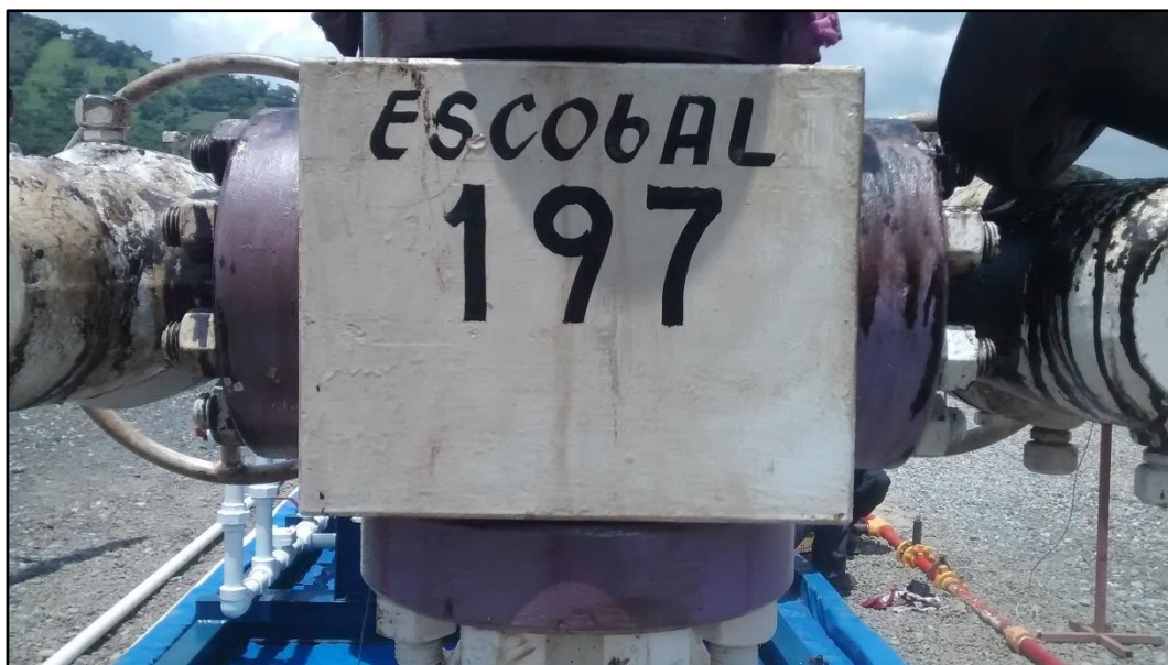
Figura 4. Árbol de válvulas perteneciente al pozo Escobal 197
