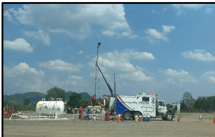
Figura 30. Unidad de línea de acero instalada en locación.
