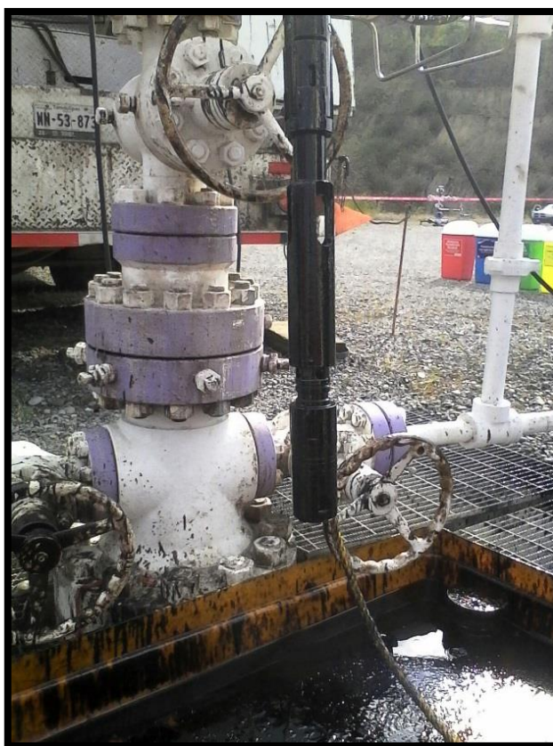
Figura 33. Válvula de pie recuperada a la superficie.
