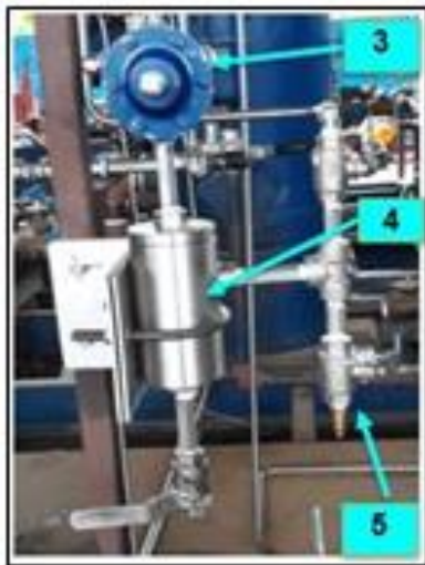
Fig.11. Válvula reguladora de alta presión.
