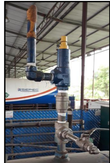
Fig.9. Válvula de seguridad.
