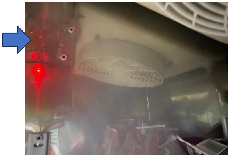
Ilustración 45 Sistema de regulación de aire funcionando correctamente
