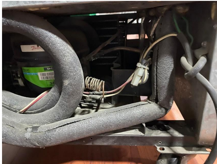
Ilustración 44 Revisión para su correcto funcionamiento
