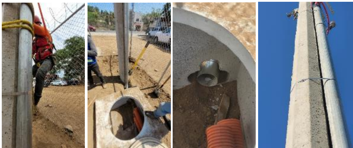
Figura 3.17: Canalización con tubo PGG sobre poste de concreto.
