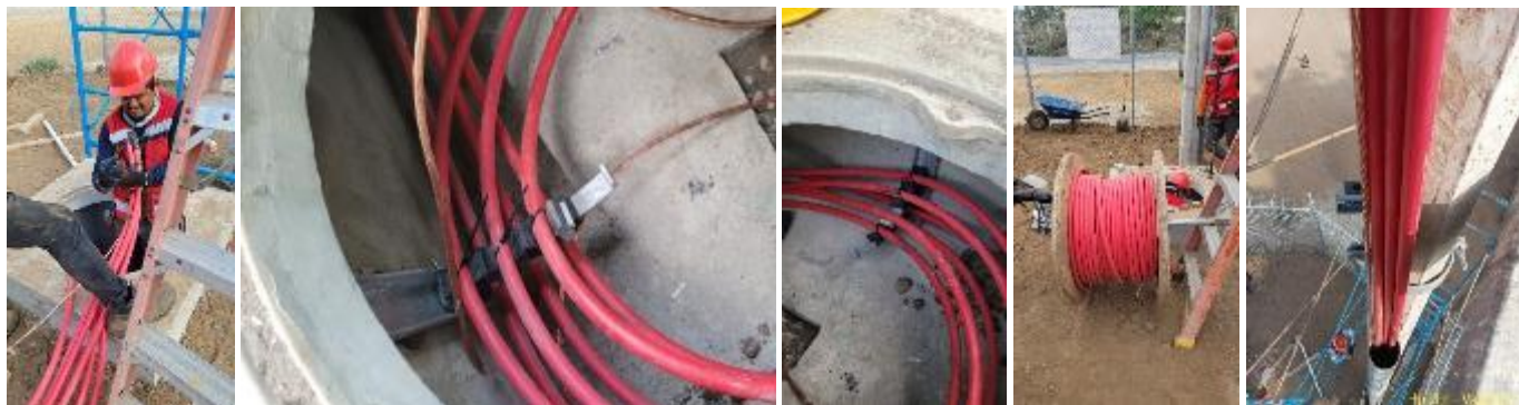
Figura 3.20: Cableado con XLP calibre 1/0
