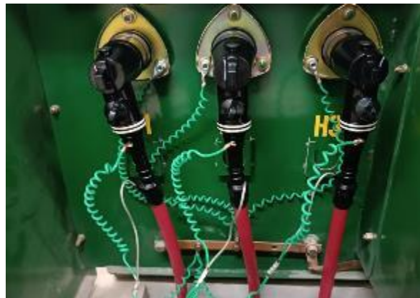
Figura 3.24: Conexión de cable XLP en transformador tipo pedestal.
