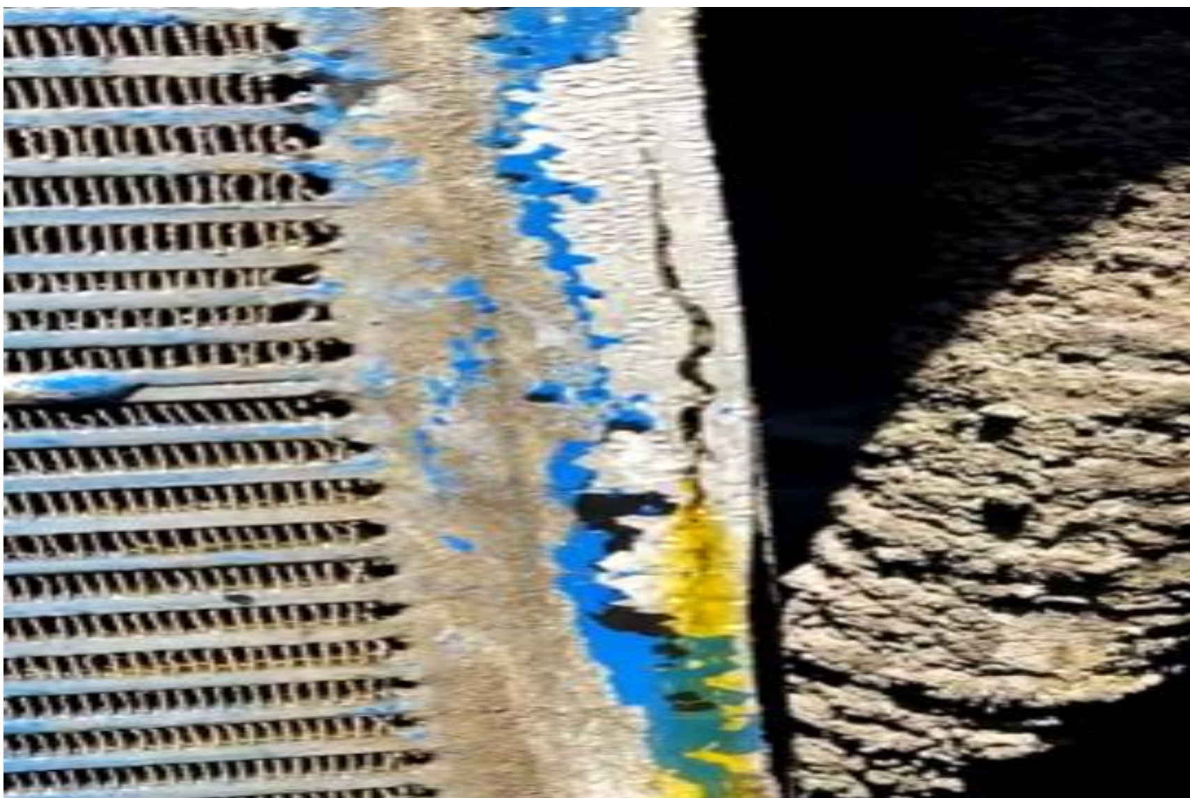
Ilustración 16 Fisura del intercambiador de calor aire forzado por sobre presión en el sistema
