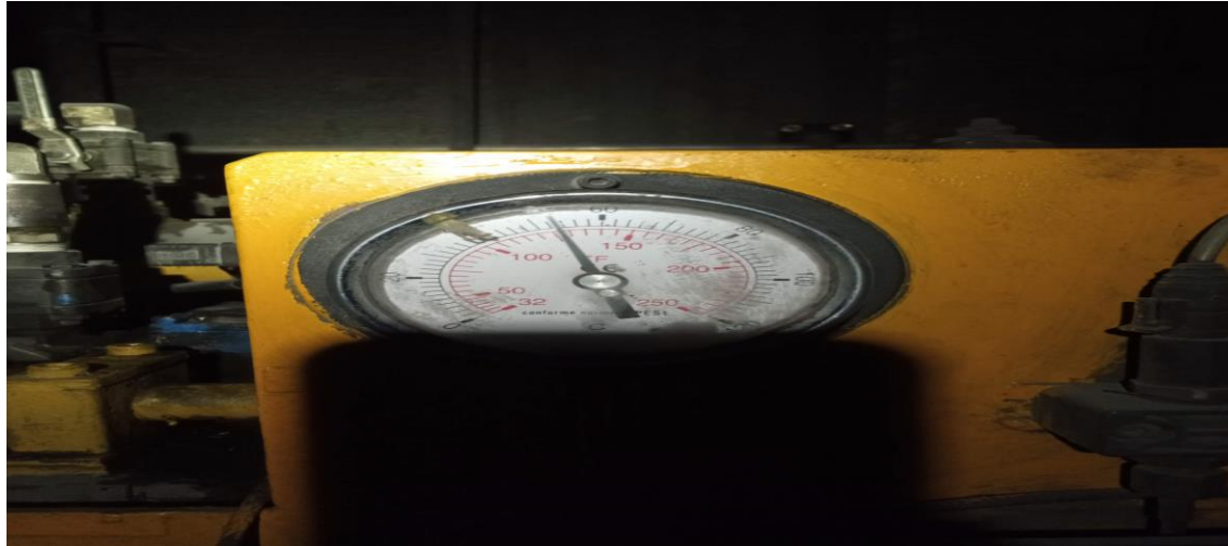
Ilustración 27 Temperatura alta en el sistema alarmado (55°C) antes de ser modificaciones
