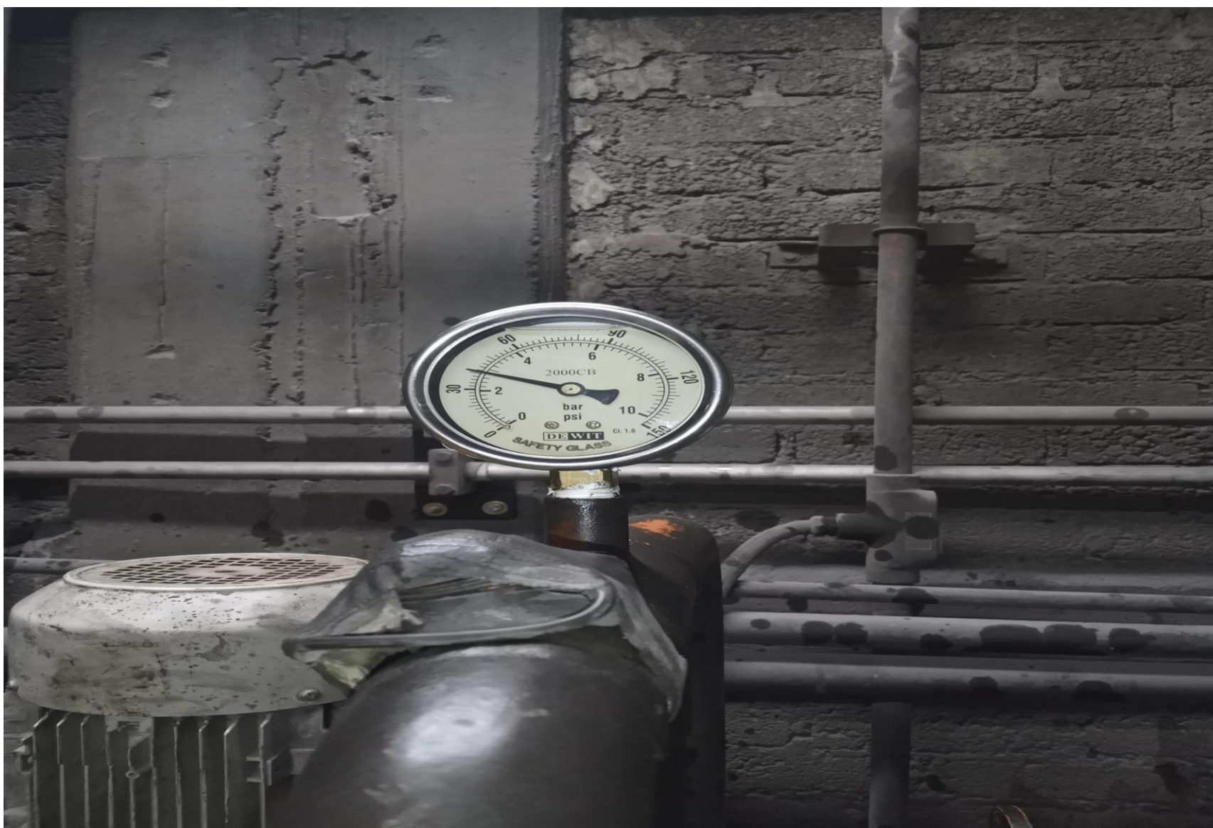
Ilustración 26 Presión de trabajo del aceite de bomba recirculación 3 bars
