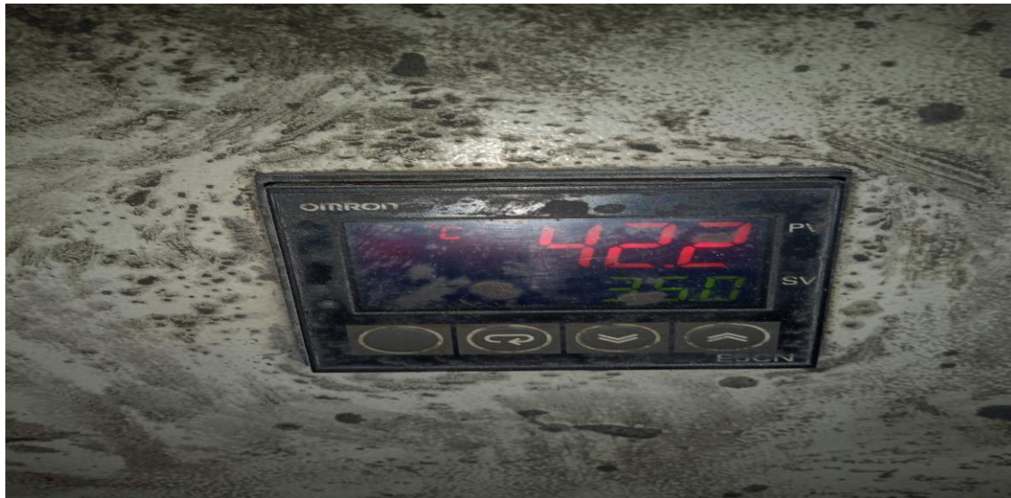
Ilustración 28 Temperatura del sistema con temperatura estable (42.2°C) despues instalar intercambiador de placas
