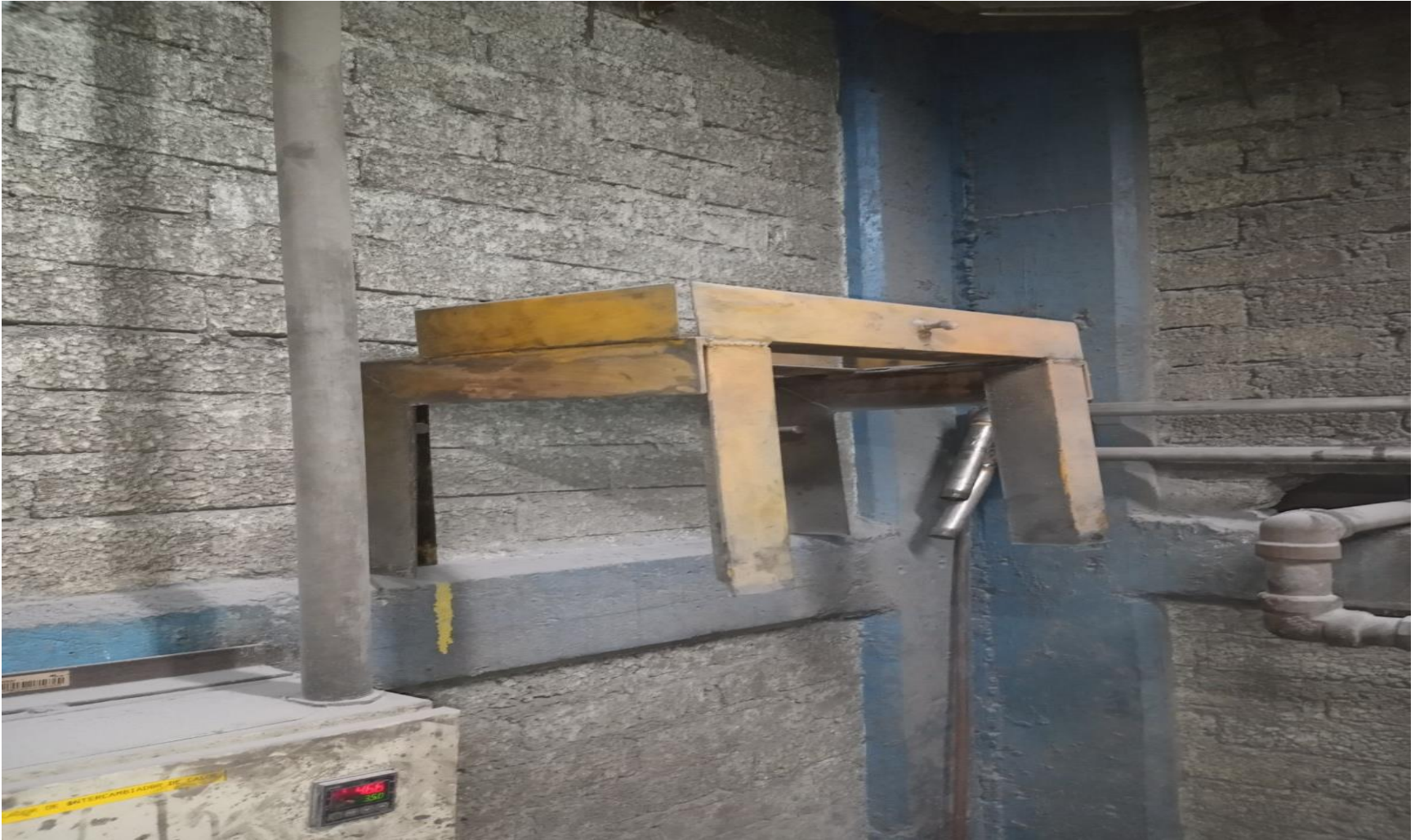
Ilustración 20 Base de intercambiador de calor instalado
