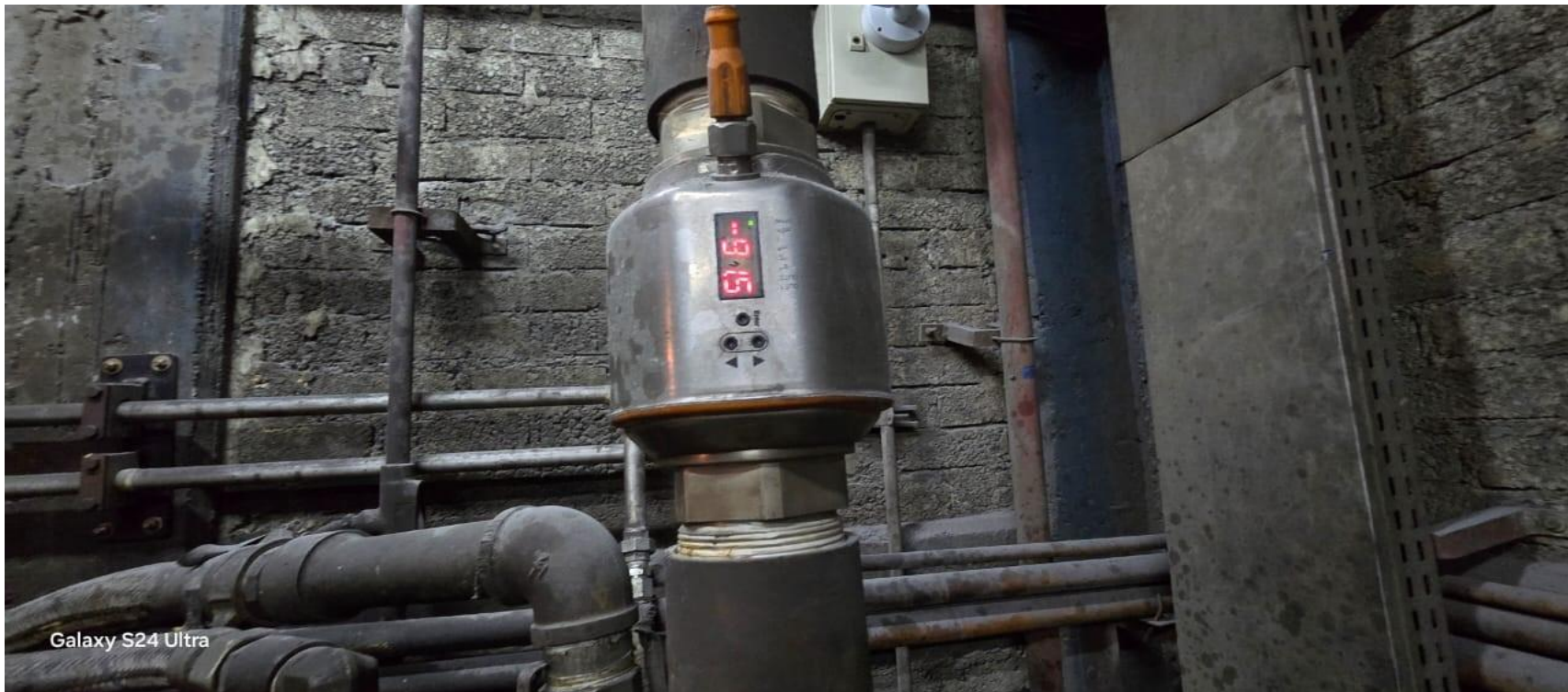
Ilustración 29 Sensor de flujo de agua IFM, línea de retorno de agua.
