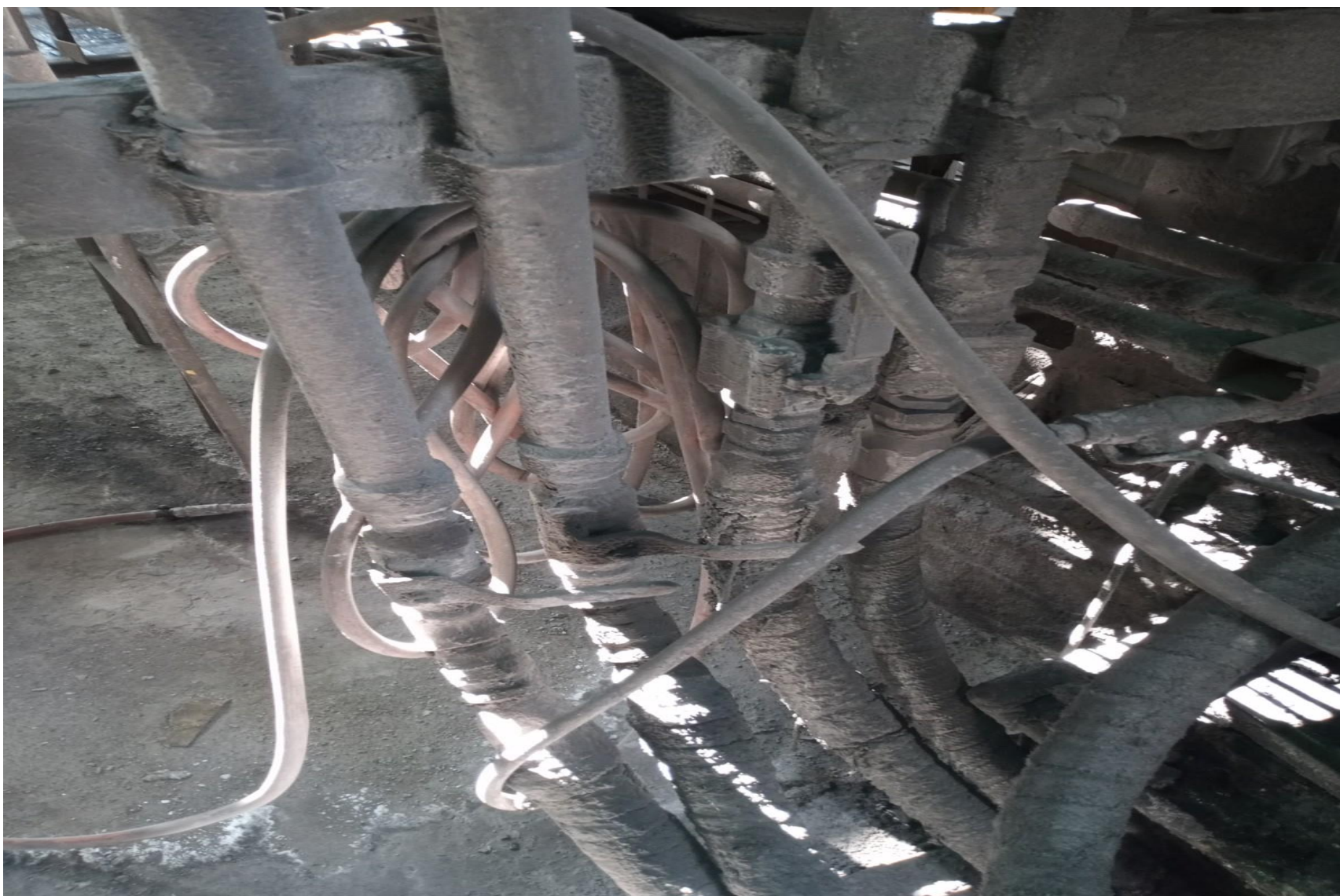
Ilustración 18 Válvulas de entrada y salida intercambiador de calor con aire forzado
