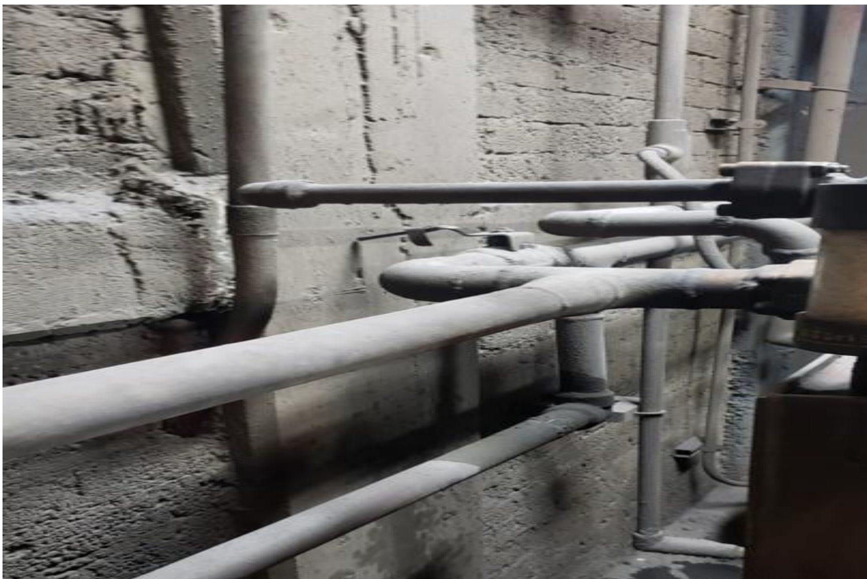
Ilustración 17 Tubería hidráulica intercambiador de calor arreglo (by pass) , para realizar mantenimiento
