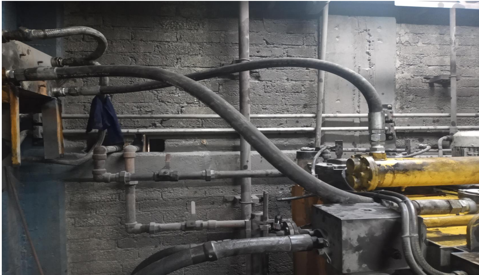
Ilustración 23 Instalación completa de sistema de enfriamiento intercambiador de placas
