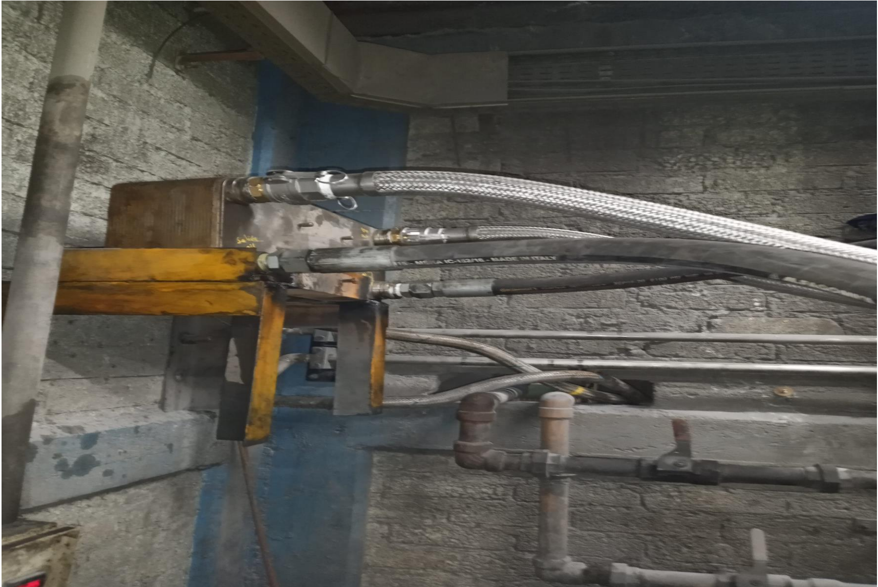
Ilustración 24 Instalación completa de sistema de enfriamiento intercambiador de placas
