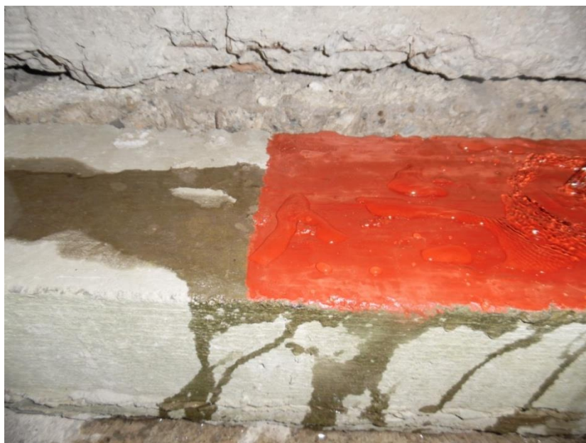
Figura 39. Prueba de aplicación de agua en el muro sobre el impermeabilizante y sin impermeabilizante sobre el mismo muro.
