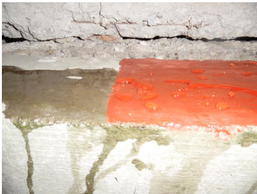
Figura 40. Prueba de aplicación de agua en el muro sobre el impermeabilizante y sin impermeabilizante sobre el mismo muro.
