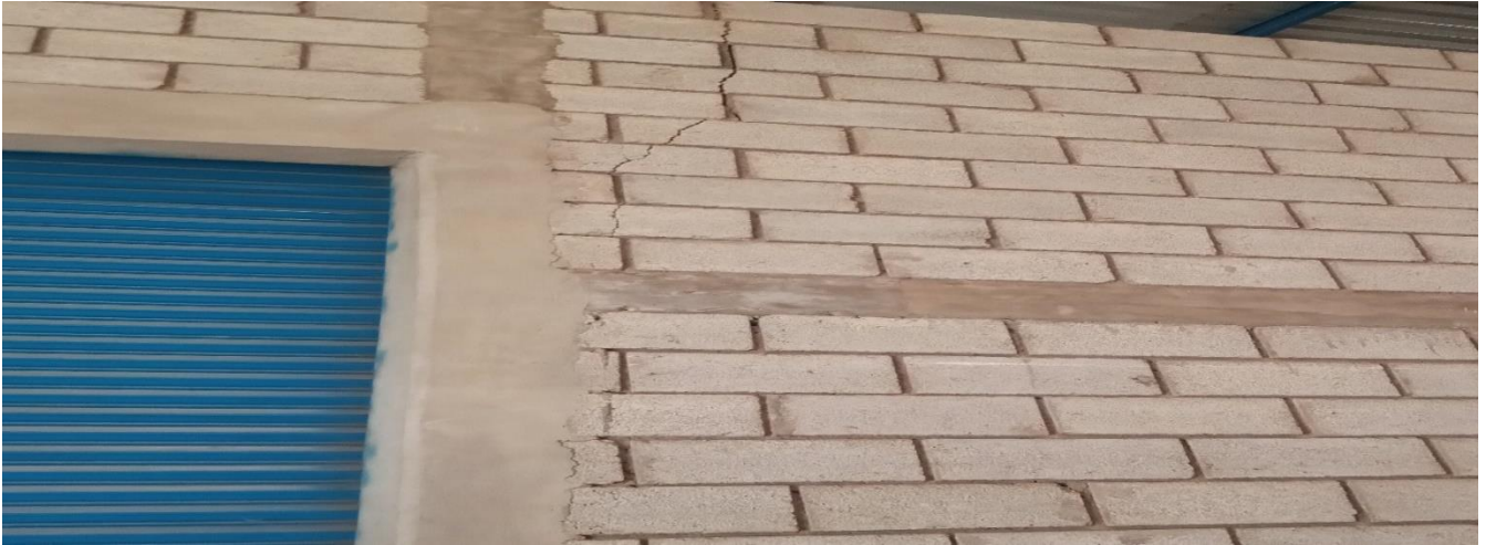
Imagen 15. Pared del almacén de insumos, donde se puede observar los daños que han causado los sismos ocurridos anteriormente.
