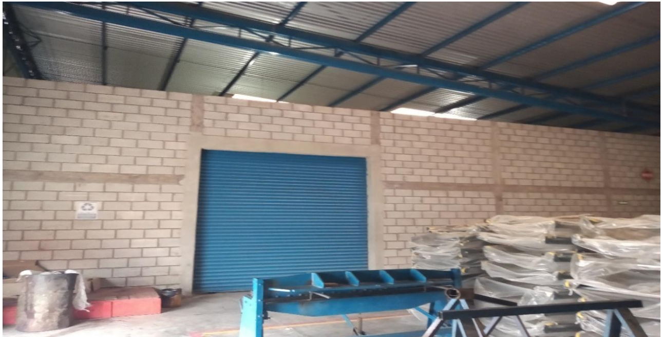
Imagen 16. Pared del área de insumos, a simple vista no se nota los daños de los sismos, pero es un riesgo para los trabajadores laborar cerca de esa área.
