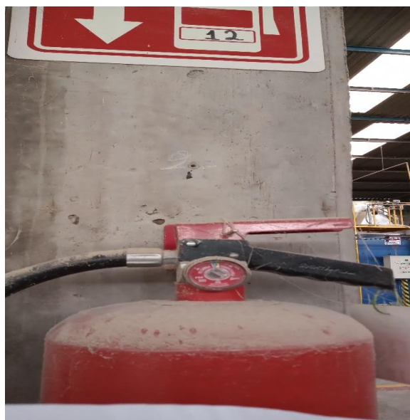
Imagen 46. Extintor sin precinto, el cual ya no cuenta con etiquetas y se encuentra en la zona verde, es decir que está cargado.
