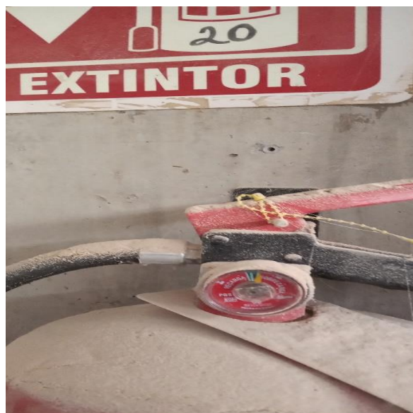
Imagen 43. Extintor sobrecargado, esto quiere decir que la presión del extintor es más elevada de lo recomendable, esto puede ser que el extintor haya sido sobrecargado o que se encuentre sometido a altas temperaturas ambientales lo que hace que aumente la presión.
