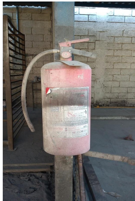
Imagen 48. Extintor en el área de pintura en malas condiciones
