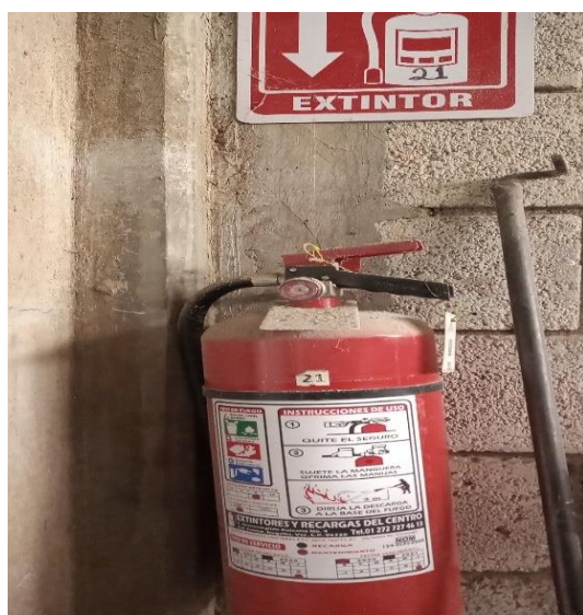
Imagen 44. La aguja del nanómetro no apunta hacia la parte verde ya que se encuentra sobrecargado
