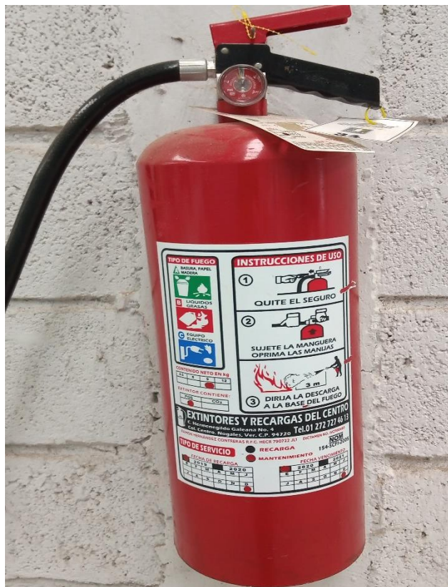
Imagen 47. Extintor en buenas condiciones
