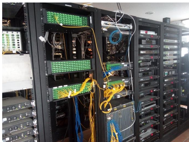
Ilustración 70. Centro de control de señal en cerritos SLP.
