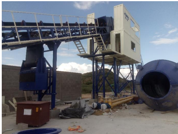
Ilustración 47. Banda transportadora que conecta con la trituradora.
