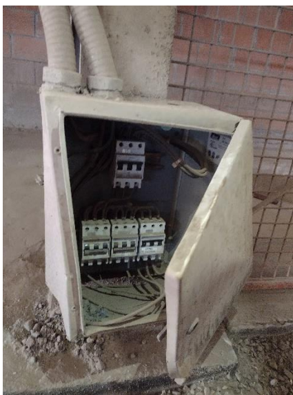
Figura 18. Tablero en mal estado
