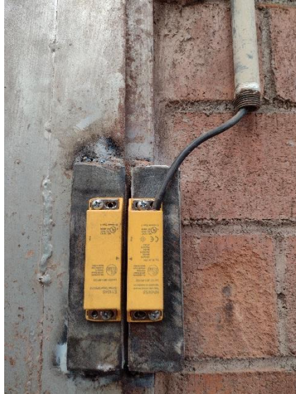
Figura 12. Detectores magnéticos instalados
