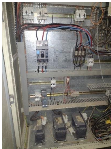
Figura 39. Interruptor termomagnético en tablero
