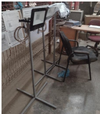
Figura 31. Reflectores instalados en soportes
