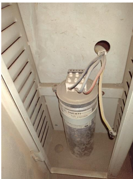
Figura 63. Capacitor de cilindro instalado
