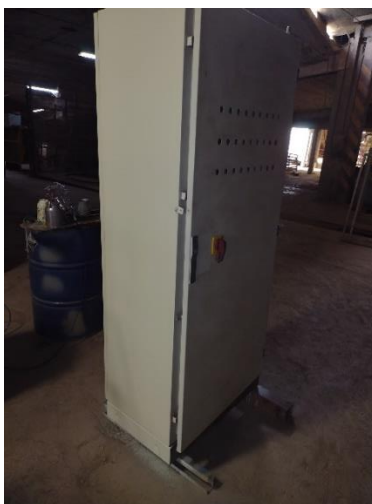
Figura 52. Tablero en mal estado
