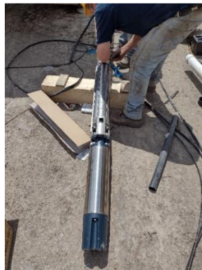
Figura 59. Motobomba y tubería nueva
