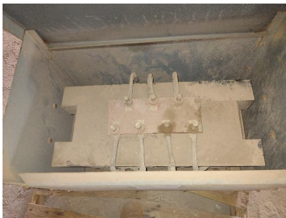
Figura 56. Transformador seco en mal estado
