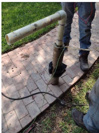
Figura 60. Bomba sumergible dañada
