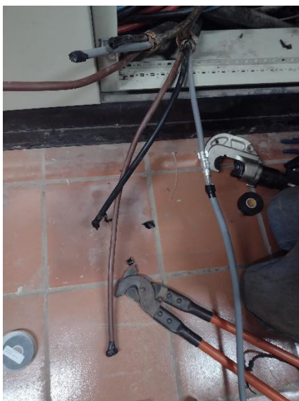
Figura 34. Cables sin empalme
