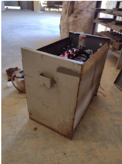
Figura 9. Transformador seco en malas condiciones
