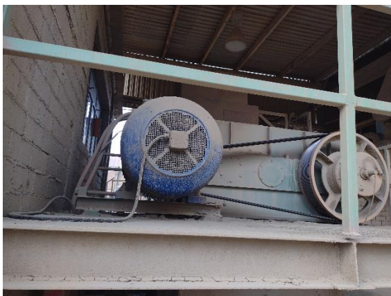
Figura 65. Motor trifásico en funcionamiento
