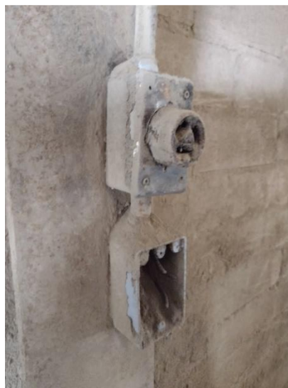
Figura 5. Contactos en mal estado
