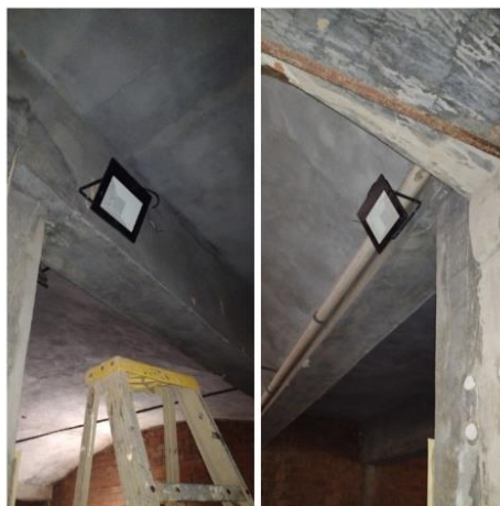
Figura 43. Reflectores de emergencia instaladas
