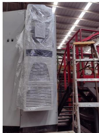
Figura 37. Aire acondicionado instalado
