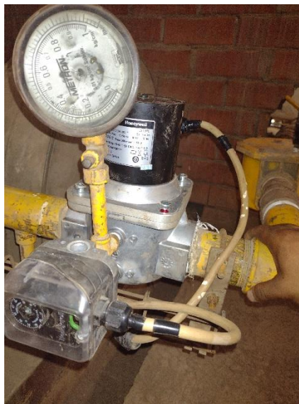
Figura 23. Cambio de electroválvula y pirómetro
