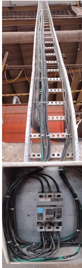
Figura 16. Cableado de interruptor
