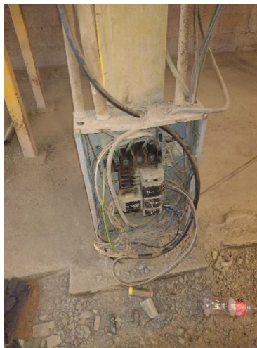
Figura 20. Centro de carga mal ubicado
