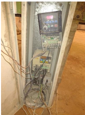
Figura 44. Tablero en mal estado
