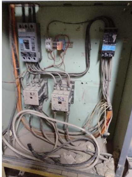
Figura 7. Tablero sin disyuntor
