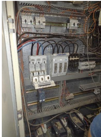
Figura 38. Fusibles en tablero
