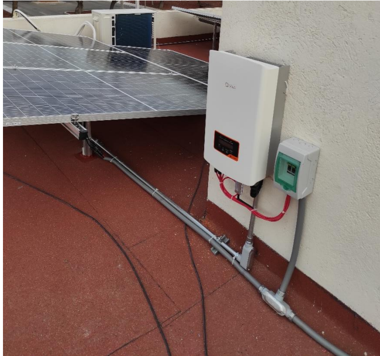
Figura 84. Canalización externa por medio de tubos conduit rígidos y flexibles tipo liquid tight.
