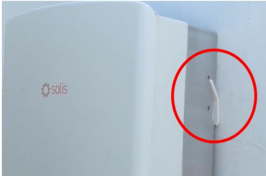
Figura 76. Montado del inversor sobre su hoja de montaje.
