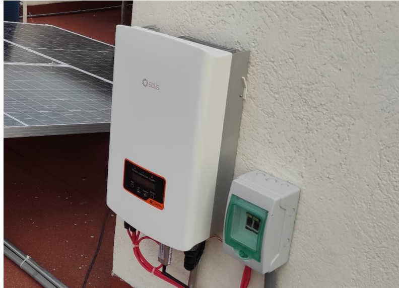
Figura 14. Inversor fotovoltaico de 5 KW de la marca Solis.
