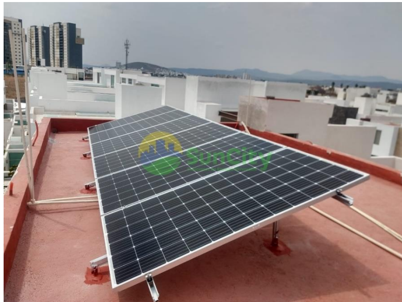
Figura 2. Instalación residencial de 2.070 kW. en Santa Fe, Juriquilla, Querétaro.
