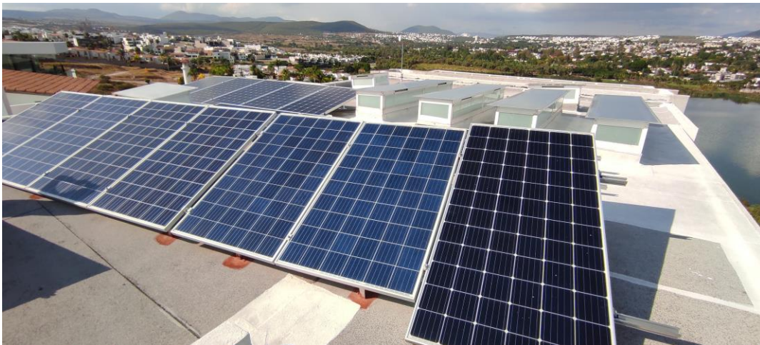
Figura 18. Paneles solares de una instalación interconectada a la red.
