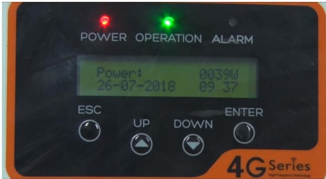
Figura 92. Operación del inversor Solis.
