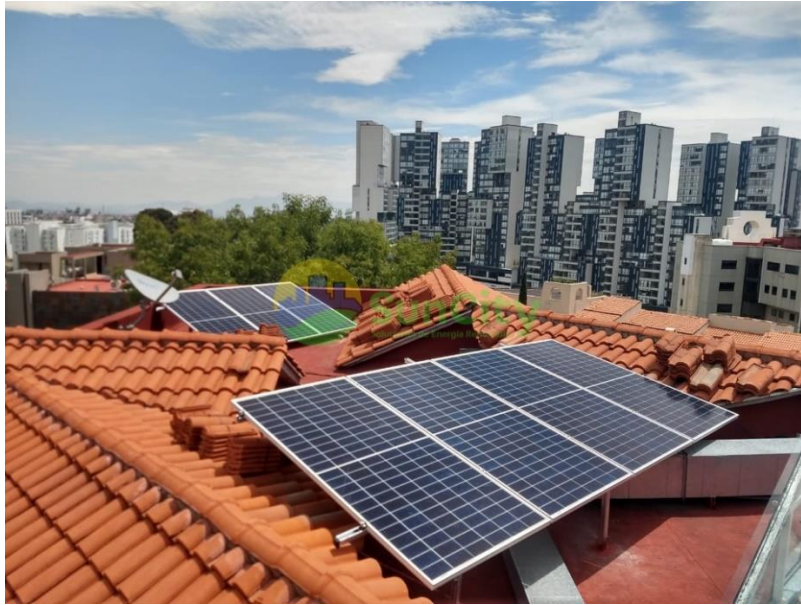
Figura 1. Instalación residencial de 5.5 kW en Bosques de las Palmas, Huixquilucan, Estado de México.
