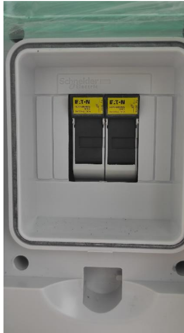
Figura 23. Fisibles de protección contenidos en los portafusibles de la marca EATON.
