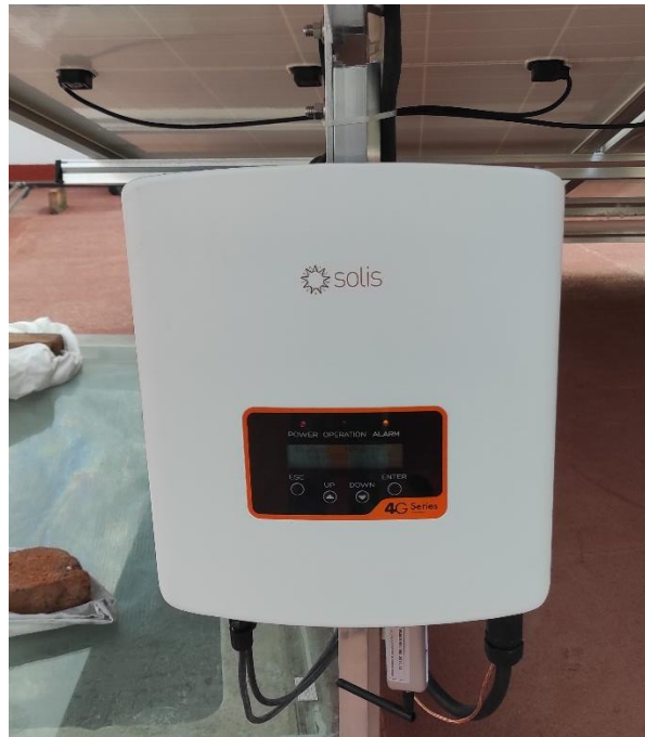
Figura 21. Inversor de corriente para aplicaciones fotovoltaicas de la marca Solís.
