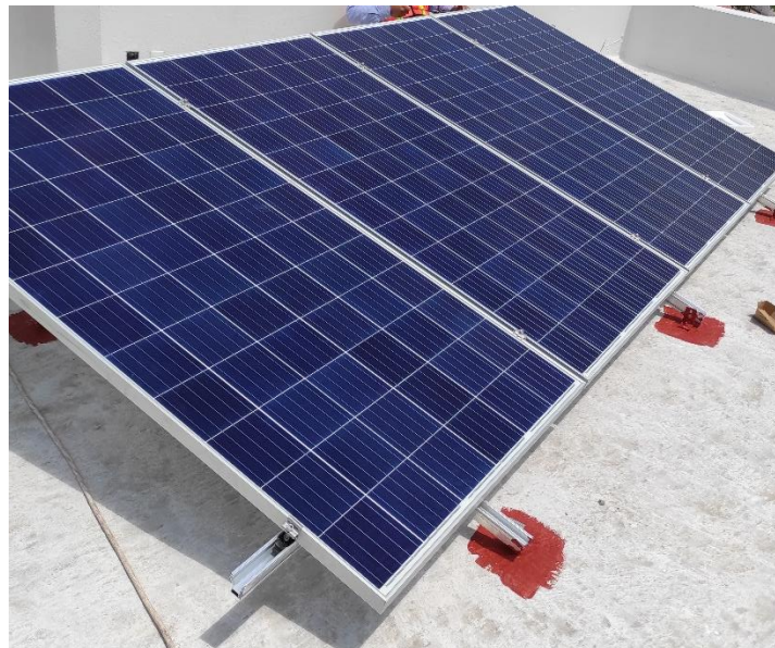
Figura 12. Módulos fotovoltaicos poli-cristalinos.
