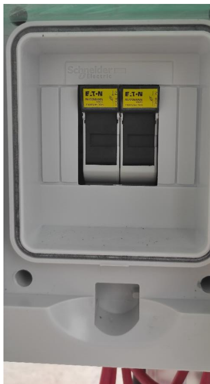
Figura 82. Sistema de protección en corriente directa.
