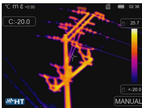
Ilustración 72.-Punto caliente en líneas
