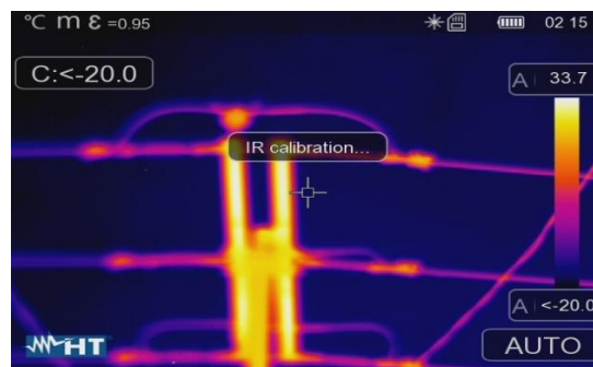
Ilustración 73.-Punto caliente en líneas
