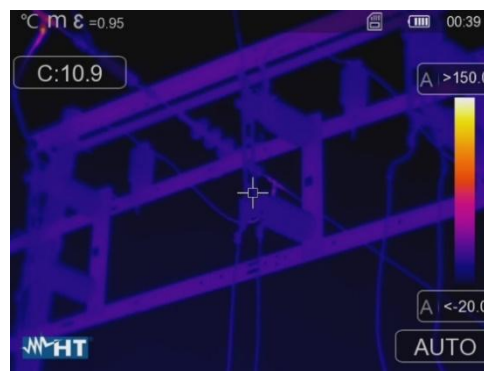
Ilustración 66.-Punto caliente en Cuchillas de operación en Grupo
