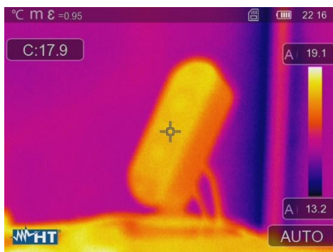
Ilustración 69.-Punto caliente en fase a
