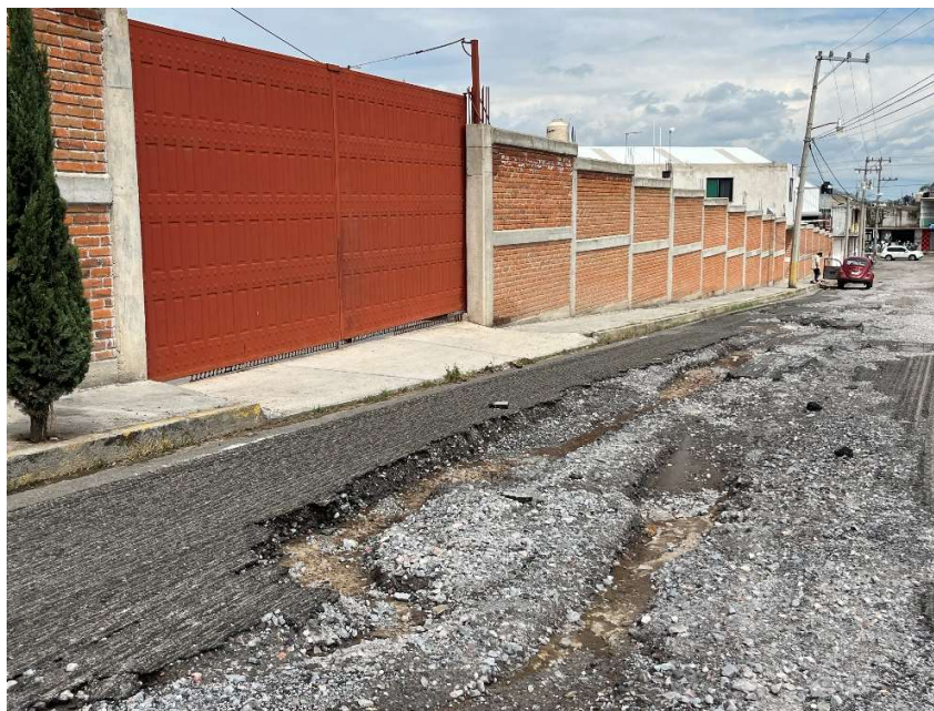
Ilustración: estado actual del bache previo a los trabajos de bacheo
