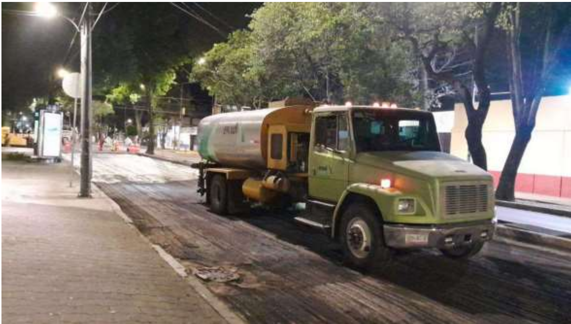
Figura 49 Petrolizadora, FRAGUA INGENIEROS
