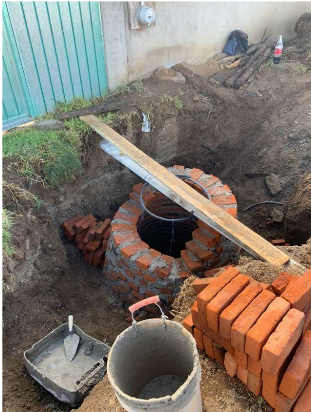
Ilustración 18 pozo de visita
