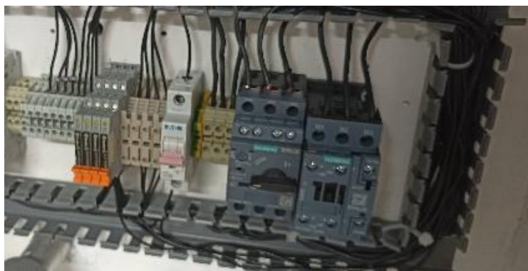
Figura 46 Guarda motor y contactor del motor
