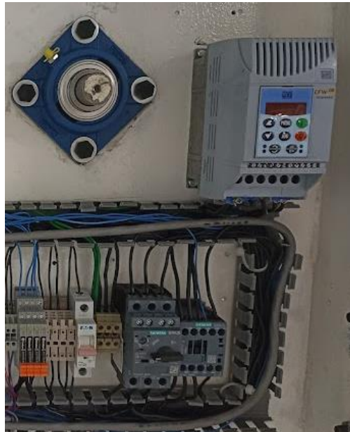
Figura 45 Variador de frecuencia y guarda motor
