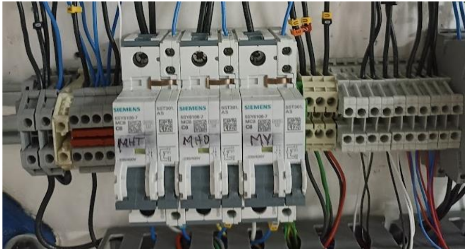
Figura 41 Disyuntores mordazas y clemas de conexión
