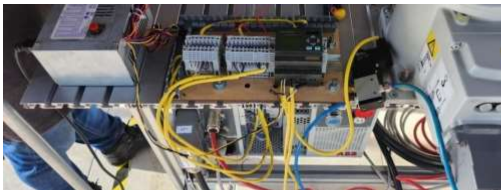
Ilustración 77 Vista general de conexiones de PLC a IRC5 Compact
