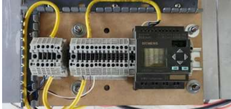
Ilustración 74 Conexiones de clemas a PLC
