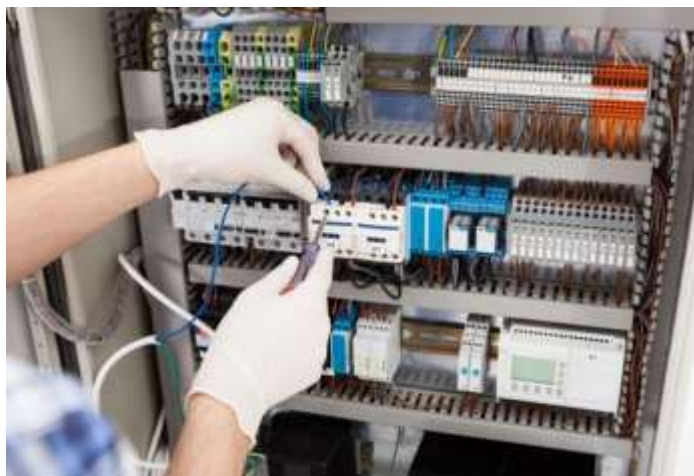
FIGURA 10 Tablero de control eléctrico (CEAC, 2020)
