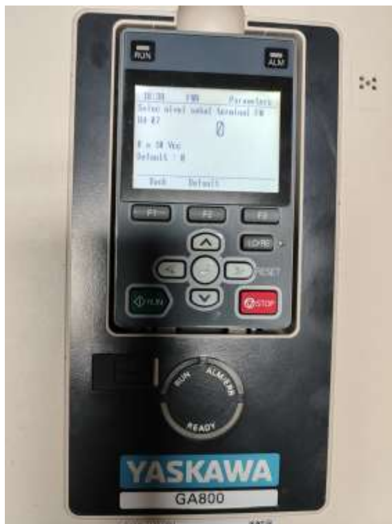
FIGURA 73 H4-07 Nivel terminal AM (Autoría Propia, 2023)
