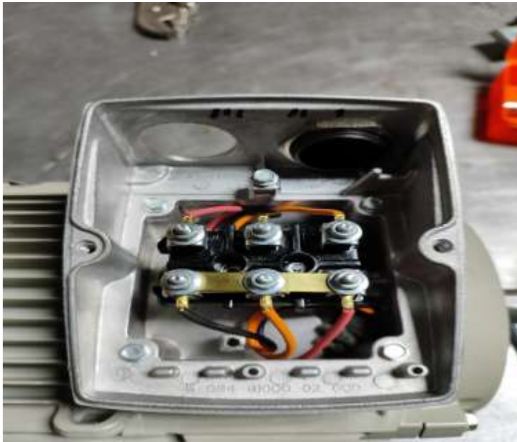
FIGURA 92 Revisión de conexiones (Autoría Propia, 2023)
