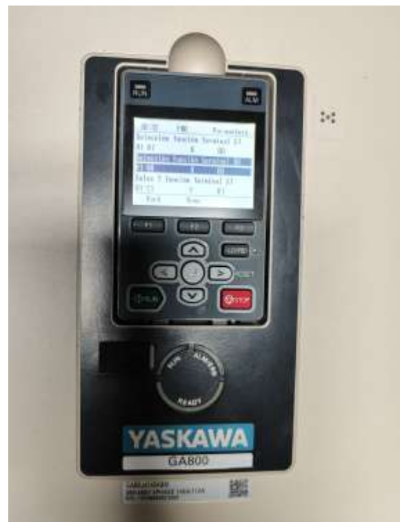
FIGURA 50 H1-01 al H1-08 Función terminal (Autoría Propia, 2023)
