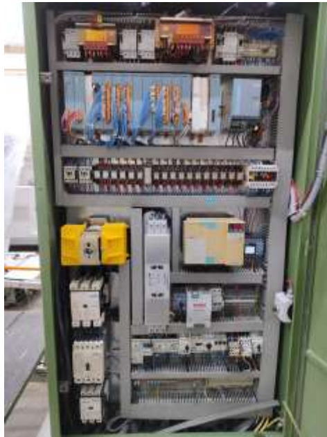
FIGURA 12 Tablero de control eléctrico de maquinaria textil (Autoría Propia, 2023)
