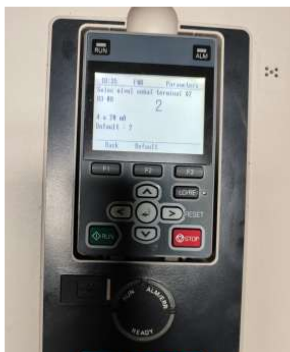
FIGURA 61 H3-09 Señal terminal A2 (Autoría Propia, 2023)
