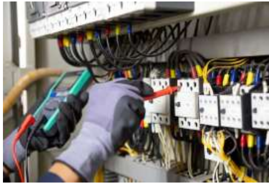
FIGURA 4 Revisión tablero de control eléctrico (CEAC, 2020)
