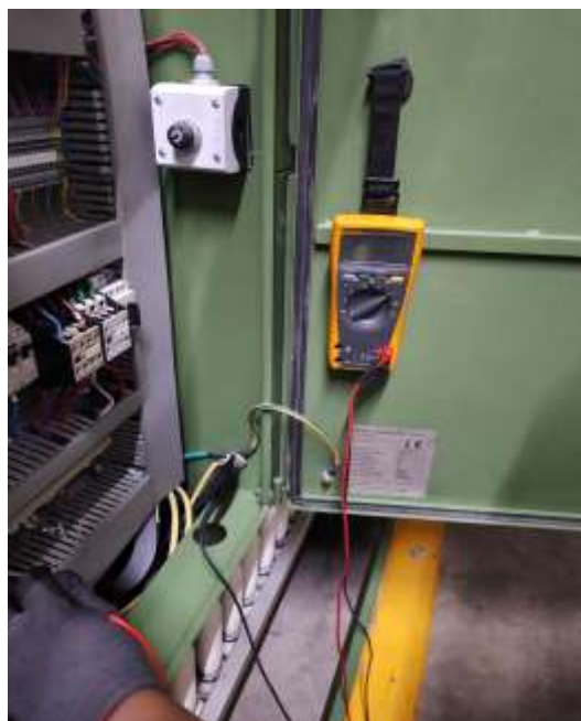
FIGURA 15 Revisión de conducción a tierra (Autoría Propia, 2023)
