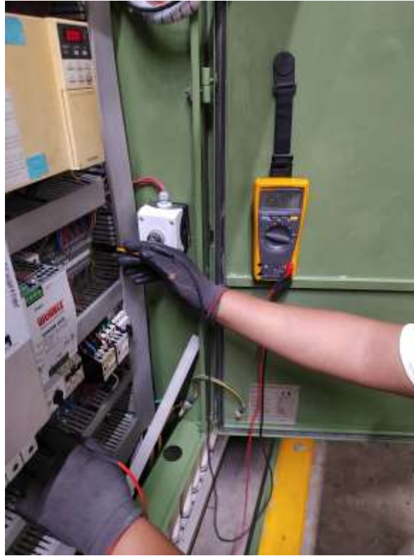
FIGURA 18 Tablero energizado (Autoría Propia, 2023)
