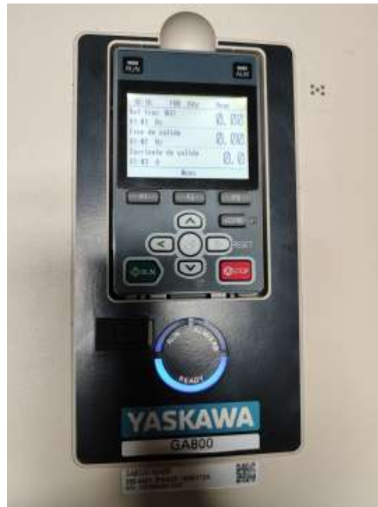
FIGURA 22 Variador de frecuencia energizado (Autoría Propia, 2023)
