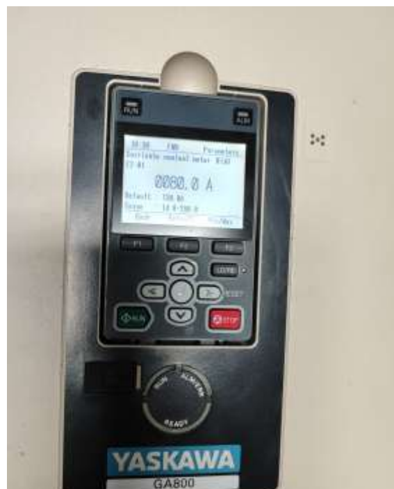
FIGURA 47 E2-02 Corriente nominal motor (Autoría Propia, 2023)
