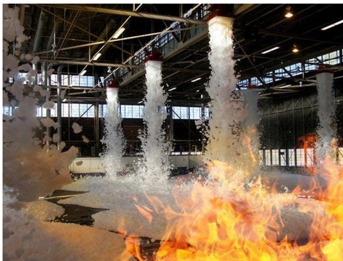
Ilustración 33: Sistema de por polvo o espuma, obtenido de (BLOG DE PREVENCIÓN Y SISTEMAS CONTRA INCENDIOS, 16 noviembre 2022)
