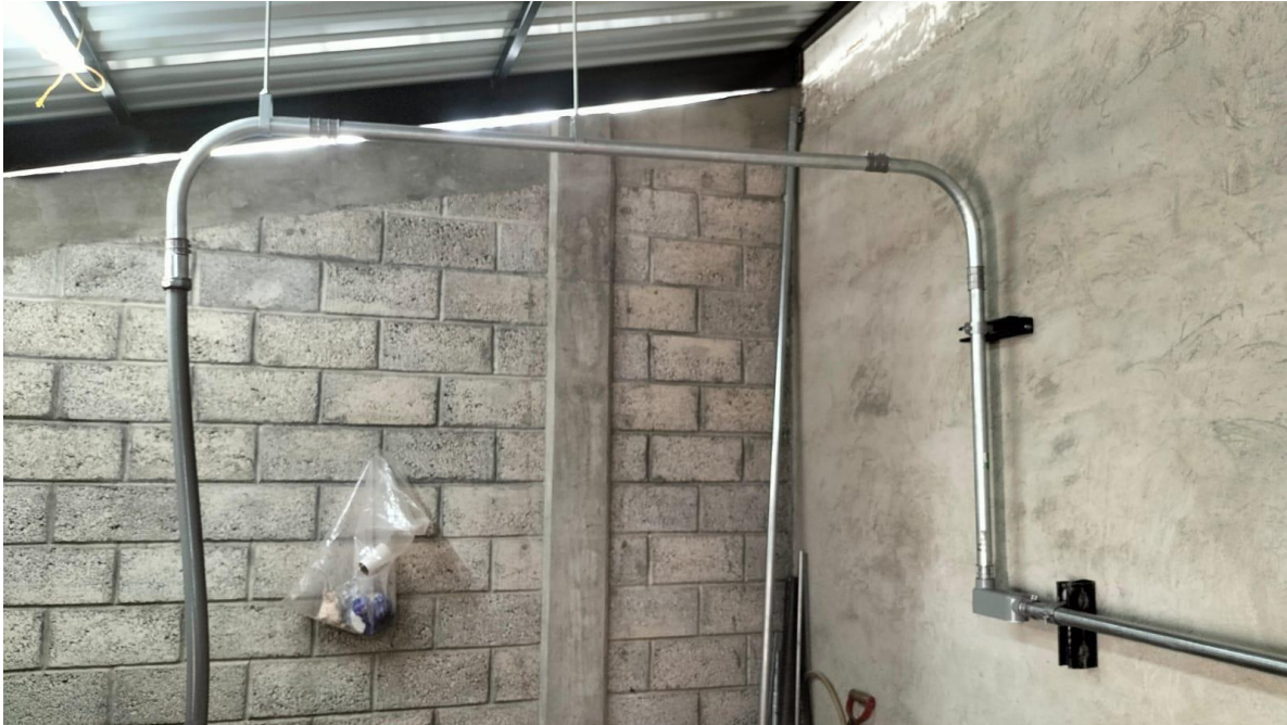
Ilustración 89: Conexión de las bombas y tablero de control al generador. Obtenido de Muñoz Reyes Jorge Alberto y Orta Reyes. Jesús Enrique, (22 diciembre 2022).
