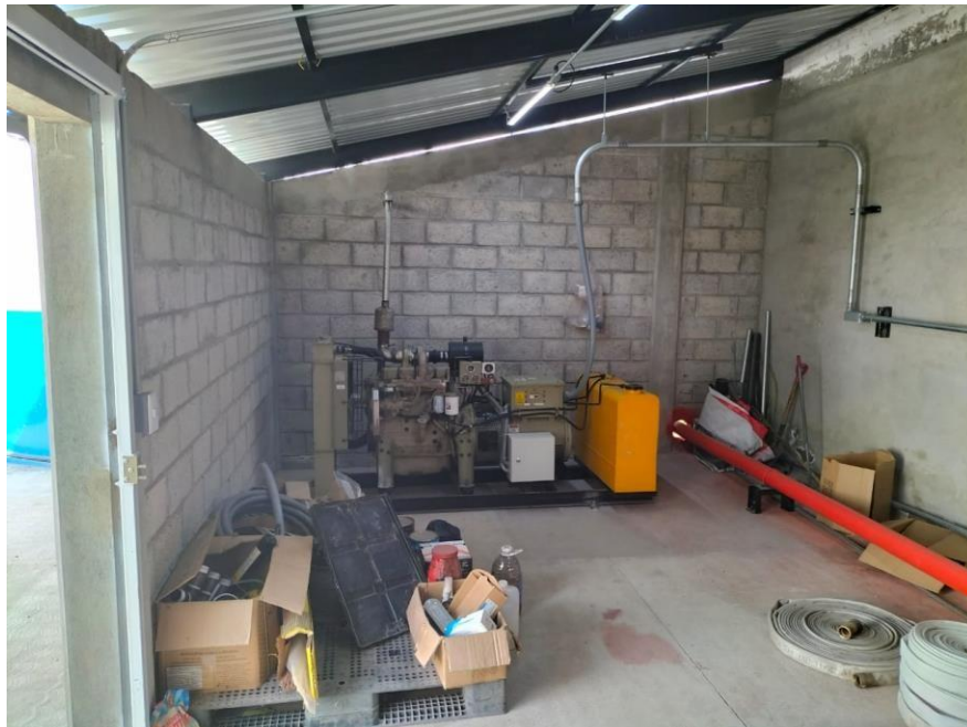
Ilustración 101: Generador eléctrico y Sistema eléctrico. Obtenido de Muñoz Reyes Jorge Alberto y Orta Reyes. Jesús Enrique, (15 enero 2023)..
