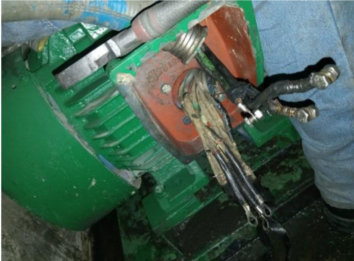
Imagen 119. Tapa de conexión de motores de bombas de fosa "L-224" . Fuente: fotografía tomada por estudiante.
