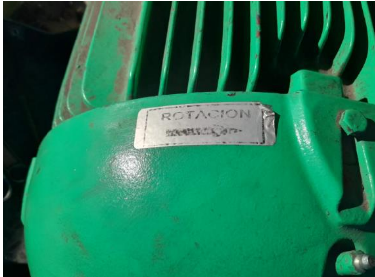
Imagen 104. Rotación de motor de bomba. Fuente: fotografía tomada por estudiante.
