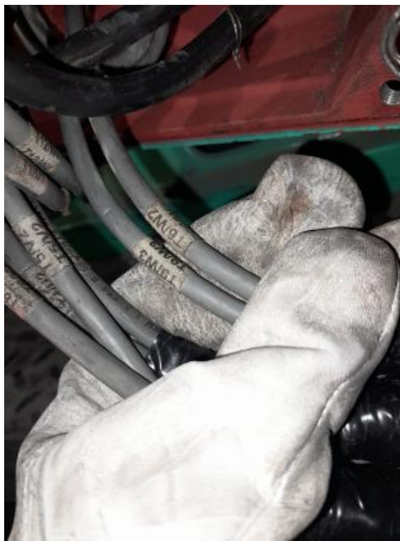
Imagen 100. Conexiones de motor de bomba (8). Fuente: fotografía tomada por estudiante.
