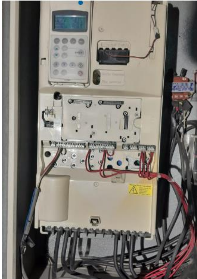
Imagen 73. Variador de riego de mesa de vaciado DC-16. Fuente: fotografía tomada por estudiante.
