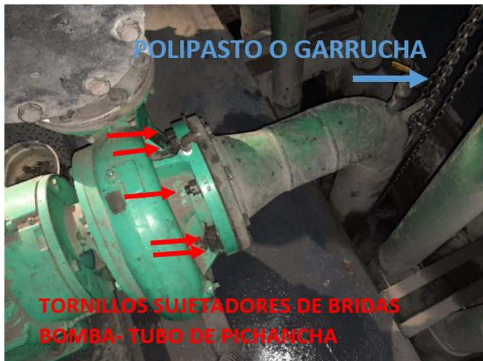
Imagen 80. Bomba nueva de riego DC-16, tornillos sujetadores de bridas bomba- tubo de pichancha. Fuente: fotografía tomada por estudiante
