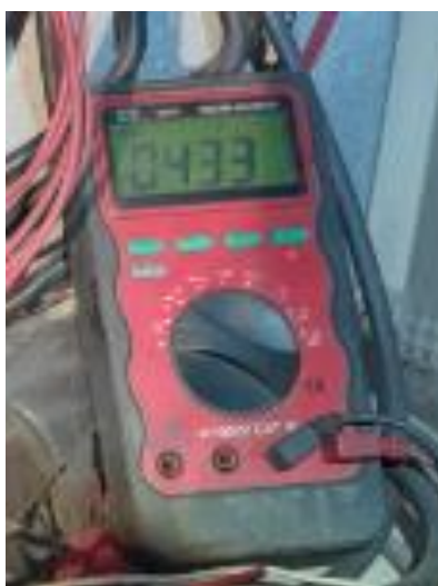
Imagen 96. Toma de lectura de voltaje de bornera de conexiones de VDF de motor de bomba de riego (2). Fuente: fotografía tomada por estudiante.
