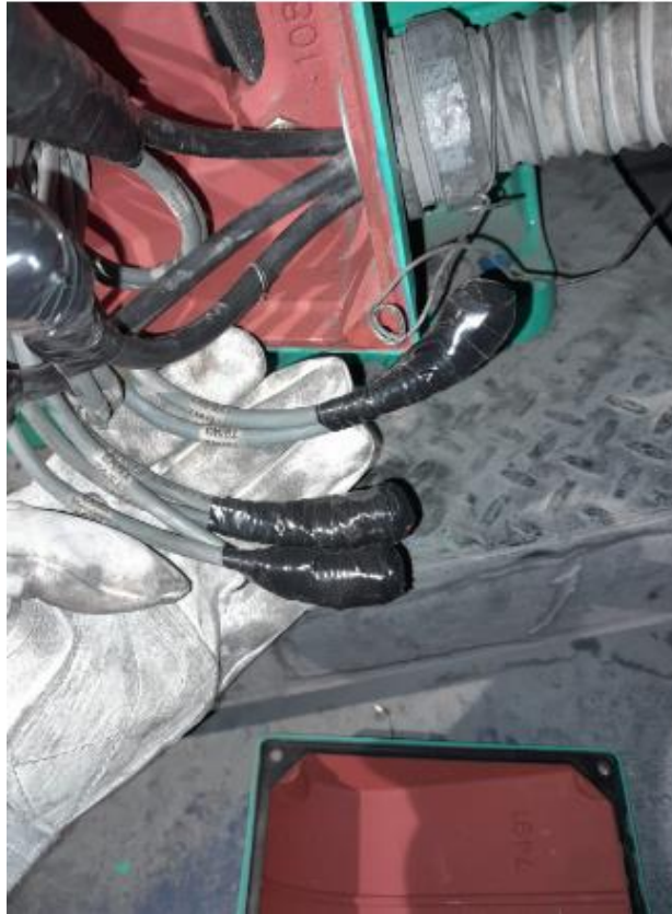
Imagen 88. Conexiones de motor de bomba. Fuente: fotografía tomada por estudiante.
