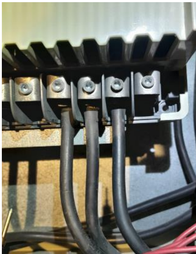
Imagen 105. Bornera de VDF de alimentación hacia el motor de bomba. Fuente: fotografía tomada por estudiante.
