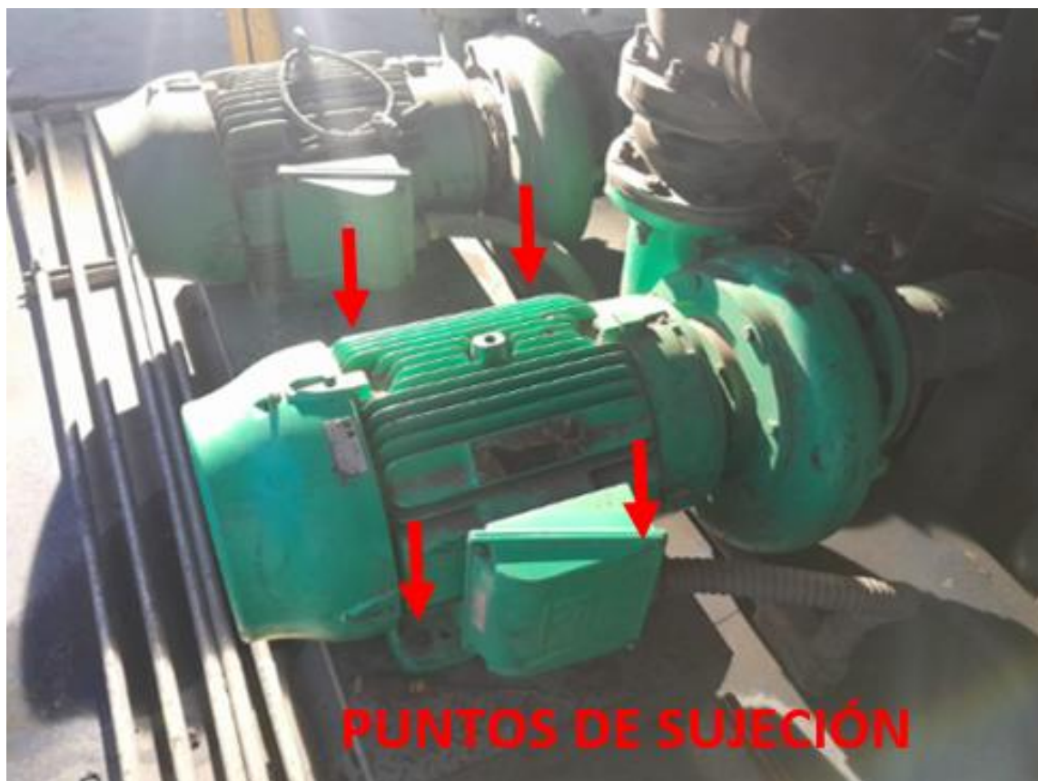
Imagen 78. Bomba nueva de riego DC-16, puntos de sujeción. Fuente: fotografía tomada por estudiante
