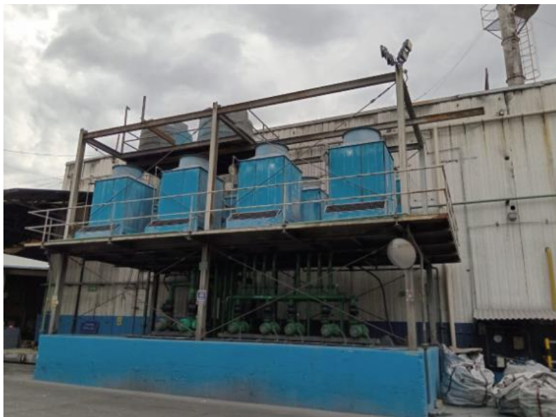
Imagen 71. Torre de enfriamiento nave #1. Fuente: fotografía 2 tomada por estudiante.
