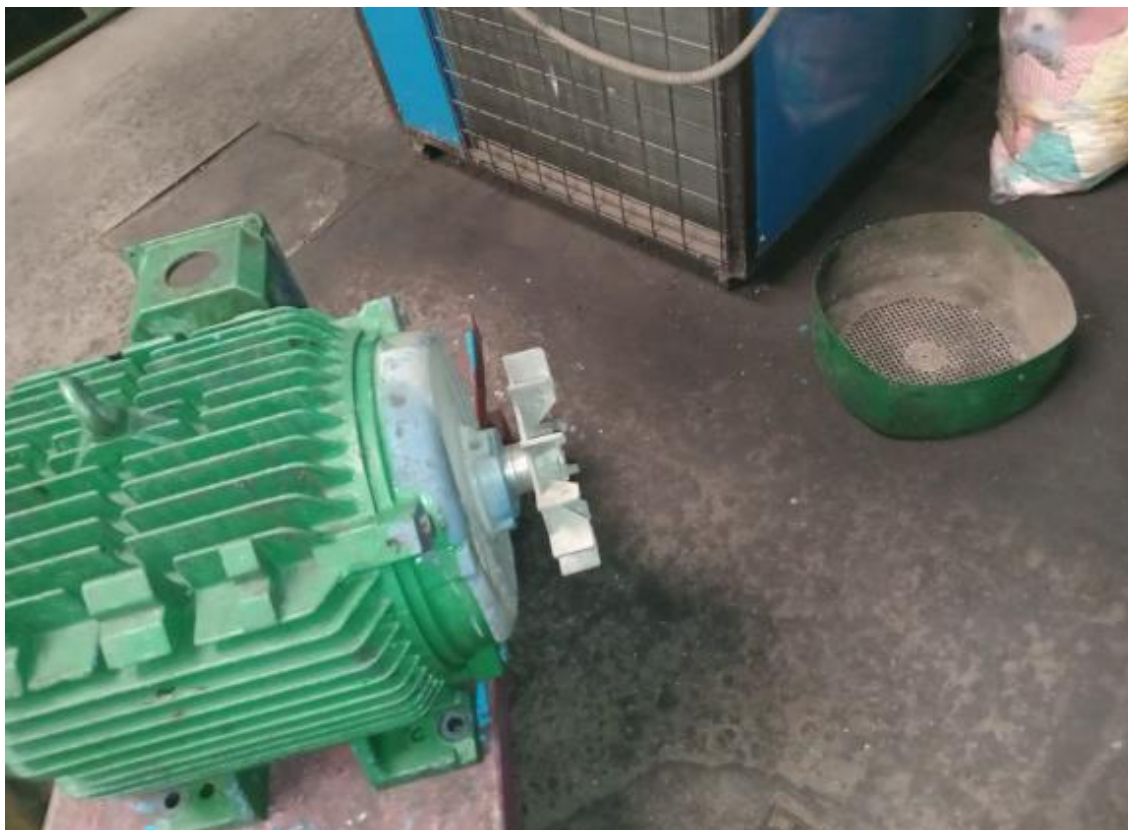
Imagen 129. Desarme de motores de fosa "L-224" (2). Fuente: fotografía tomada por estudiante.
