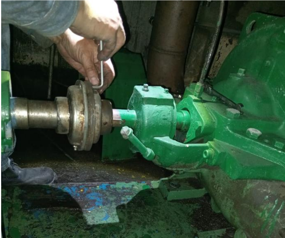
Imagen 118. Tapas de motores de bombas de fosa "L-224" . Fuente: fotografía tomada por estudiante.
