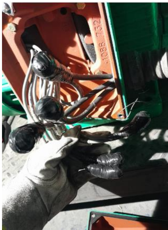
Imagen 89. Conexiones de motor de bomba (2). Fuente: fotografía tomada por estudiante.
