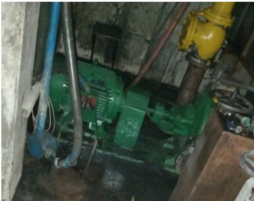
Imagen 117. Motores de bombas de fosa “L-224”. Fuente: fotografía tomada por estudiante.
