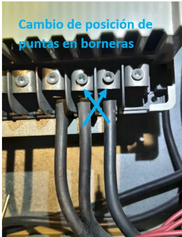
Imagen 106. Cambio de rotación en bornera de VDF de alimentación hacia el motor de bomba. Fuente: fotografía tomada por estudiante.
