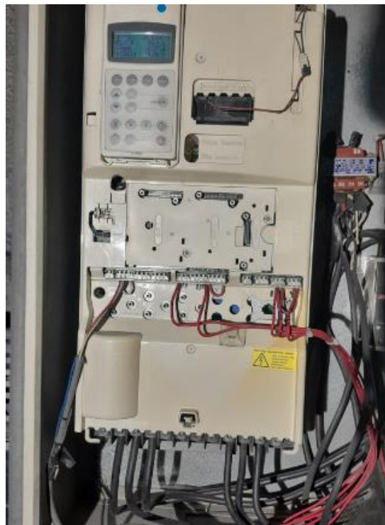
Imagen 93. VDF de motor de bomba de riego. Fuente: fotografía tomada por estudiante.
