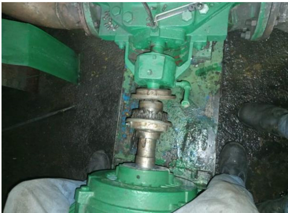
Imagen 120. Rejillas de acople falk de motores de bombas de fosa "L-224" . Fuente: fotografía tomada por estudiante.
