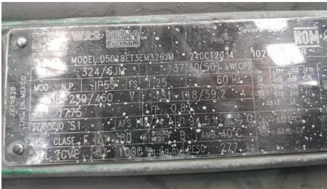
Imagen 77. Placa de datos de bomba de riego DC-16. Fuente: fotografía tomada por estudiante
