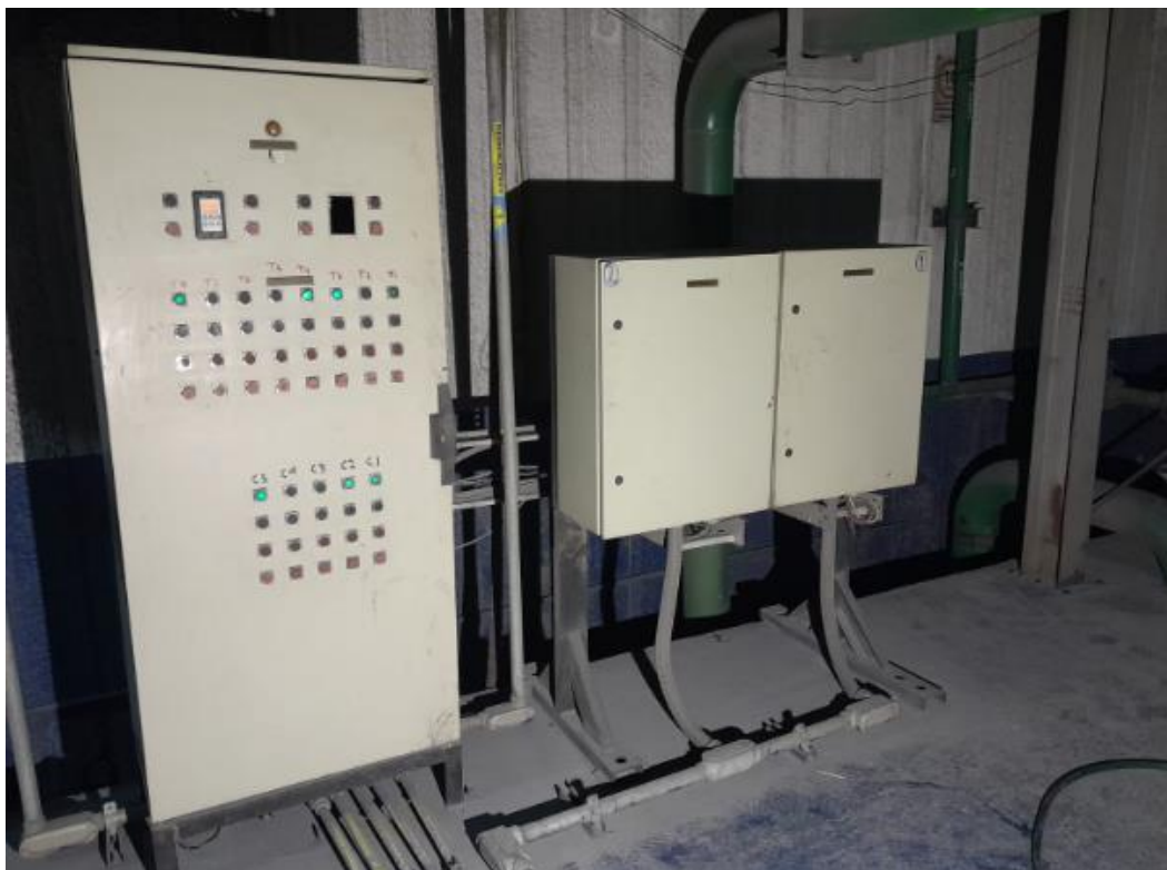
Imagen 72. Gabinete de control de torre de enfriamiento nave #1. Fuente: fotografía tomada por estudiante.
