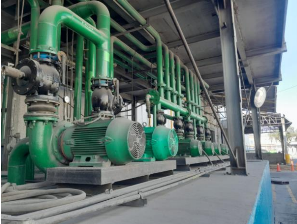
Imagen 68. Bombas de torre de enfriamiento nave #1. Fuente: fotografía tomada por estudiante.
