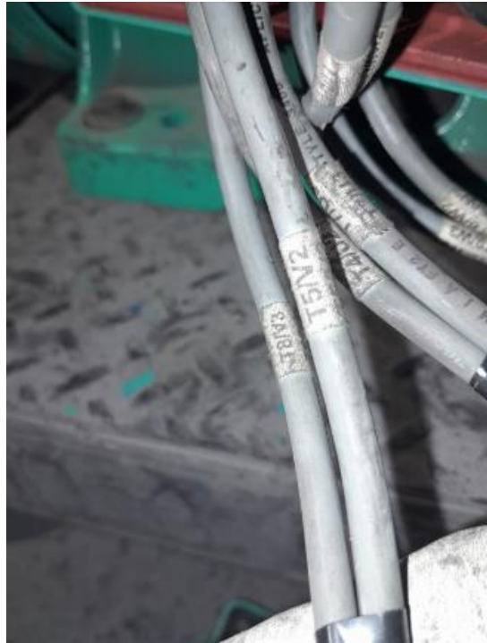
Imagen 102. Conexiones de motor de bomba (10). Fuente: fotografía tomada por estudiante.
