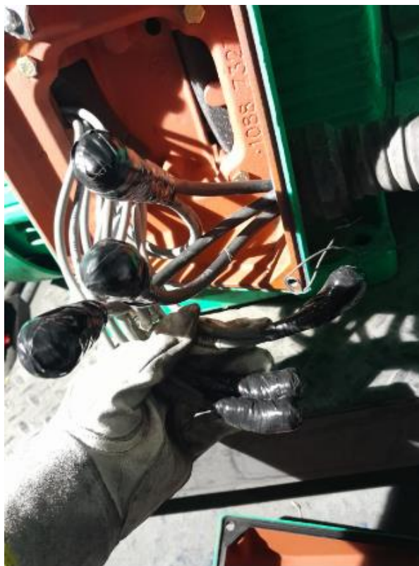
Imagen 90. Conexiones de motor de bomba (3). Fuente: fotografía tomada por estudiante.
