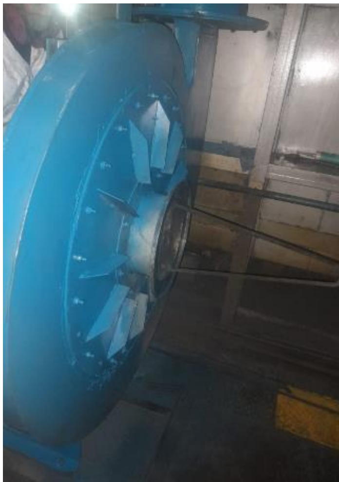
Imagen 107. Base de filtro de aire motor de combustión. Fuente: fotografía tomada por estudiante.
