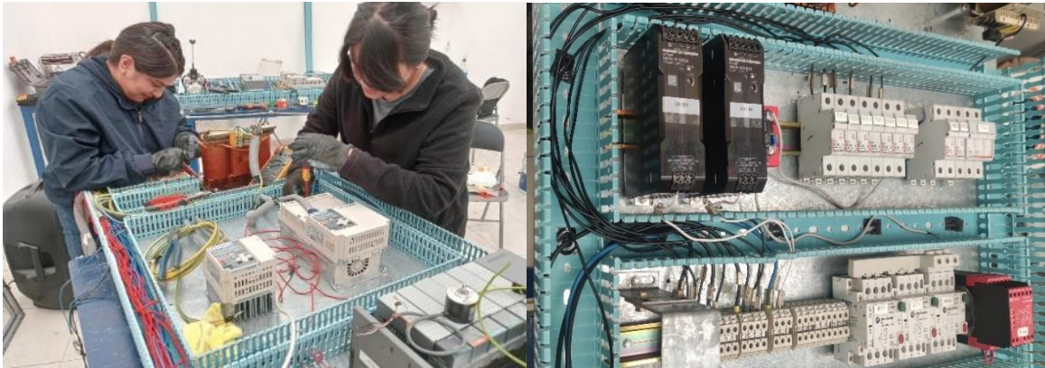
Figura 27 Cableado de componentes
