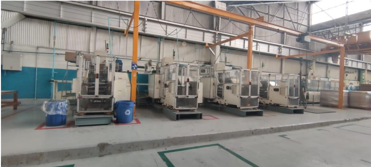
Figura 43 Línea “C” funcionando
