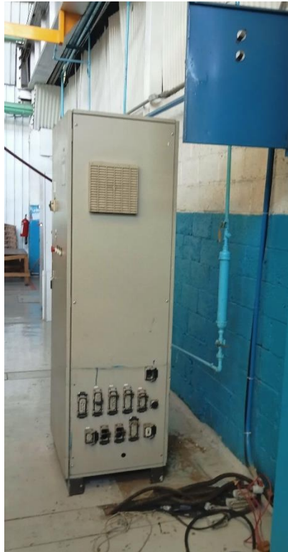
Figura 4 Desenergización de gabinetes
