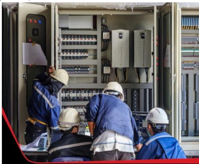
Figura 2.3 Gabinete eléctrico. (We Connect and Protect, 2022)
