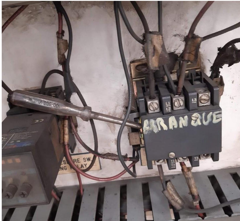
Figura 3.9 Contactor de máquina Banbury 6.
