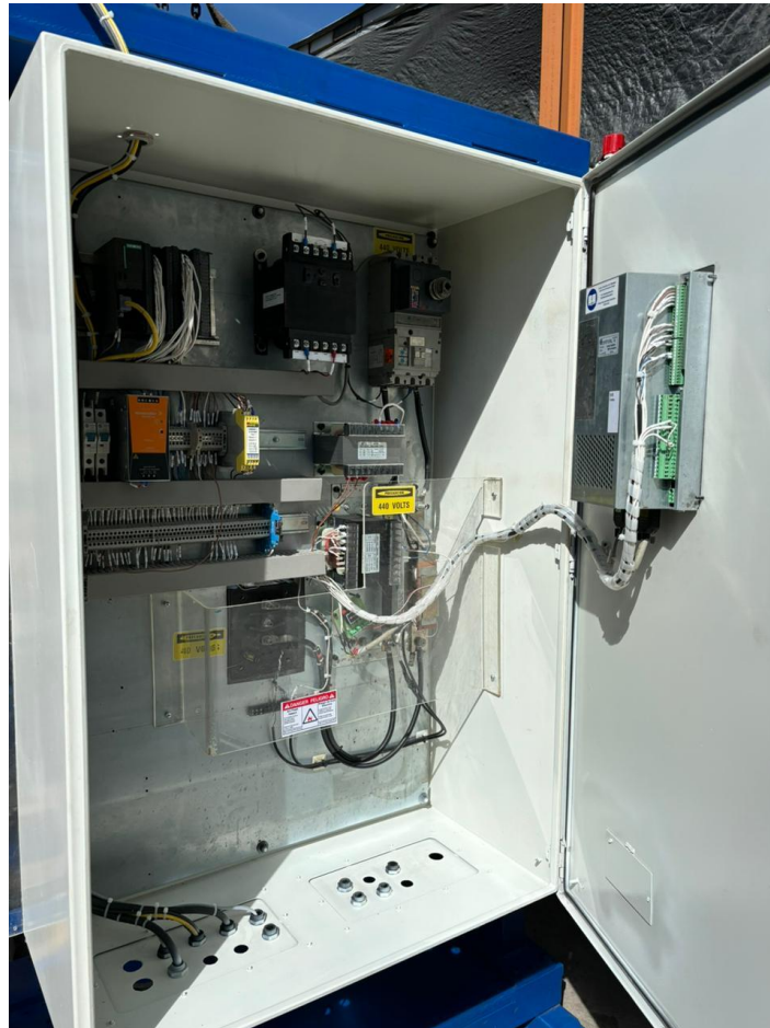
Ilustración 21. Tablero electrico de estacion
