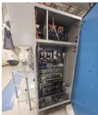
Ilustración 23 Gabinete eléctrico feeder
