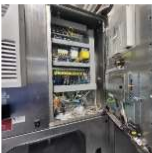
Ilustración 35 Gabinetes eléctricos prensa eléctrica.
