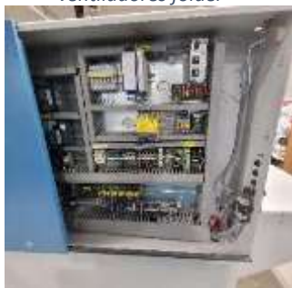
Ilustración 17 Gabinete eléctrico folder
