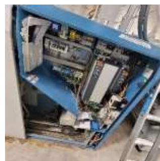
Ilustración 28 Gabinete eléctrico iron
