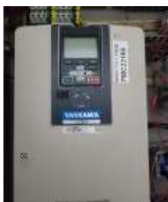
Ilustración 5 Convertidor de frecuencia
