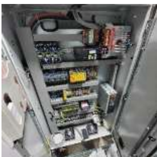
Ilustración 39 Gabinete eléctrico secadora
