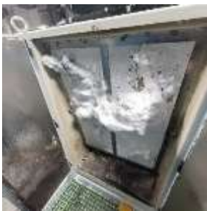
Ilustración 41 Filtros de aire secadora
