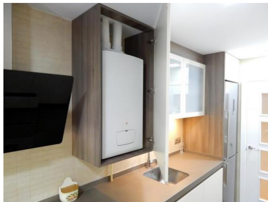
Figura 3.- Caldera de cocina
