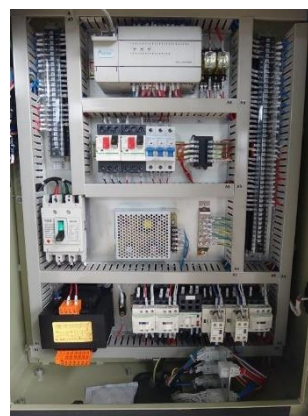
Figura 3.2 Interior tablero de control.
