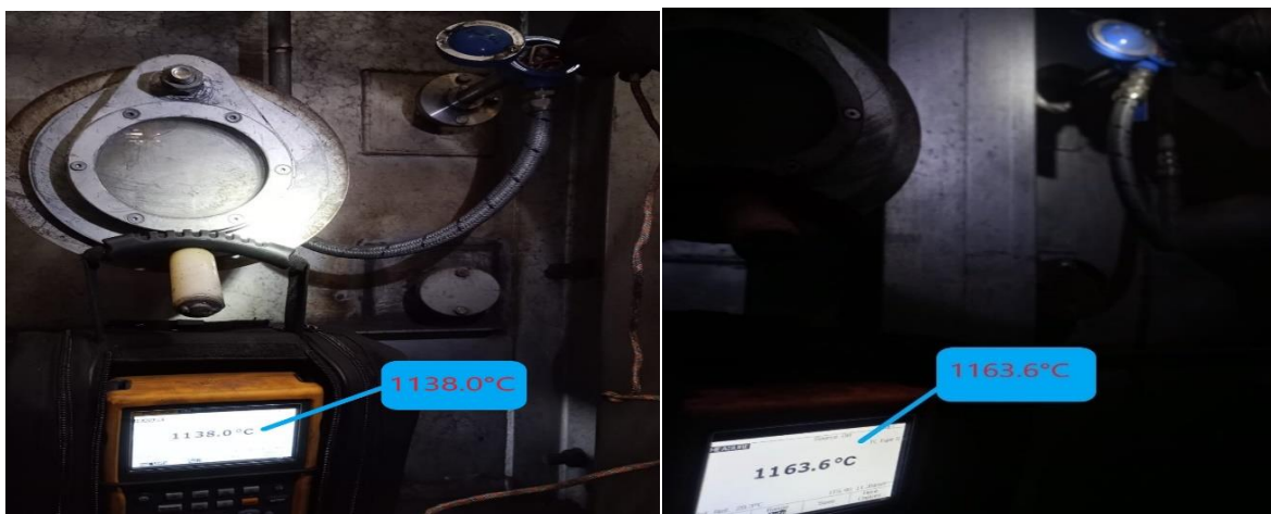
Imagen 75: Temperatura del termopar 1 y 2 de la zona 2 medida con un calibrador de procesos.
