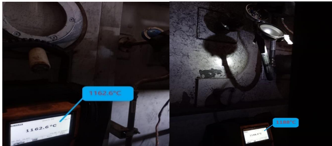
Imagen 72: Temperaturas del termopar 1 y 2 medidas con un calibrador de procesos.
