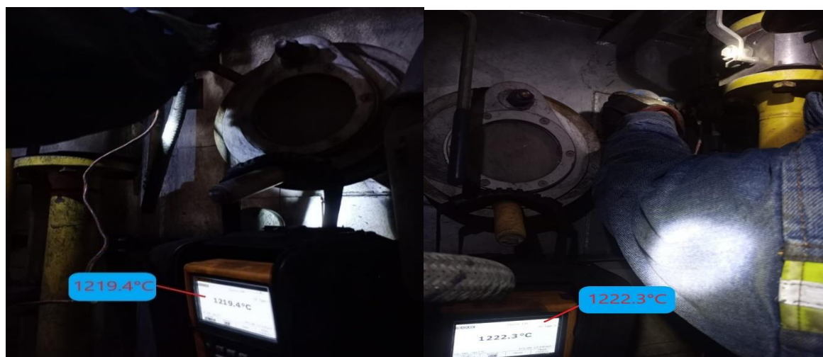
Imagen 86: Temperaturas del termopar 1 y 2 de la zona 6 medidas con un calibrador de procesos.
