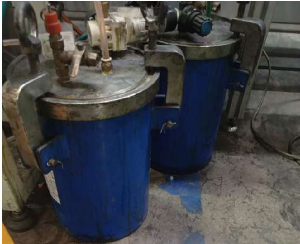
Figura 3.9 Tanques de presión
