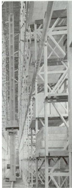
Figura 4.25 Elevador del sistema computarizado de almacenamiento.
