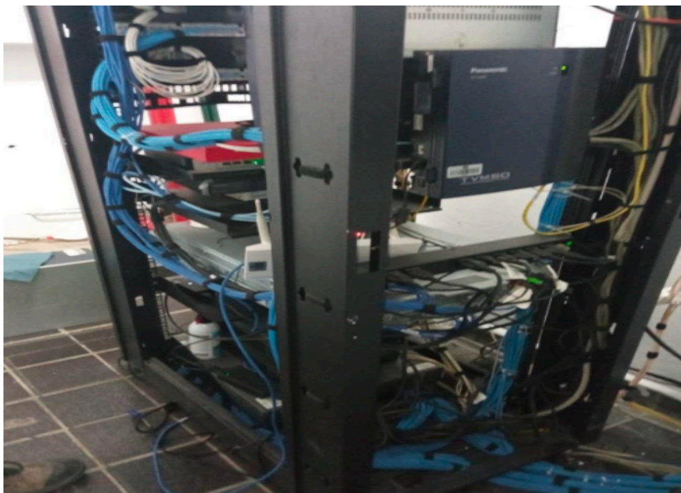
Aquí finalmente están los cables de red y de servicios en el rack principal en su cuarto de servidores
