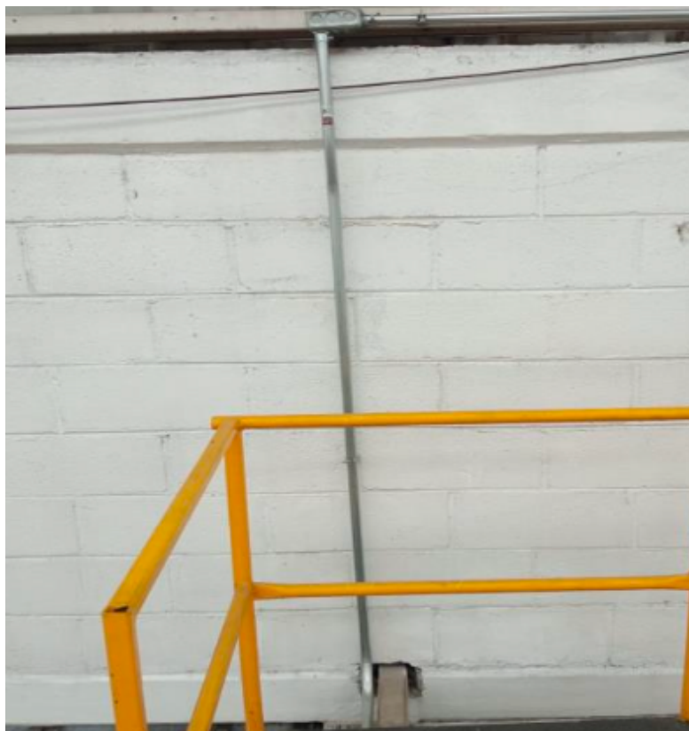
Aquí esta una imagen se puede ver como se puso tubo galvanizado en la parte de afuera del almacén para proteger los servicios especiales y los cables de red
