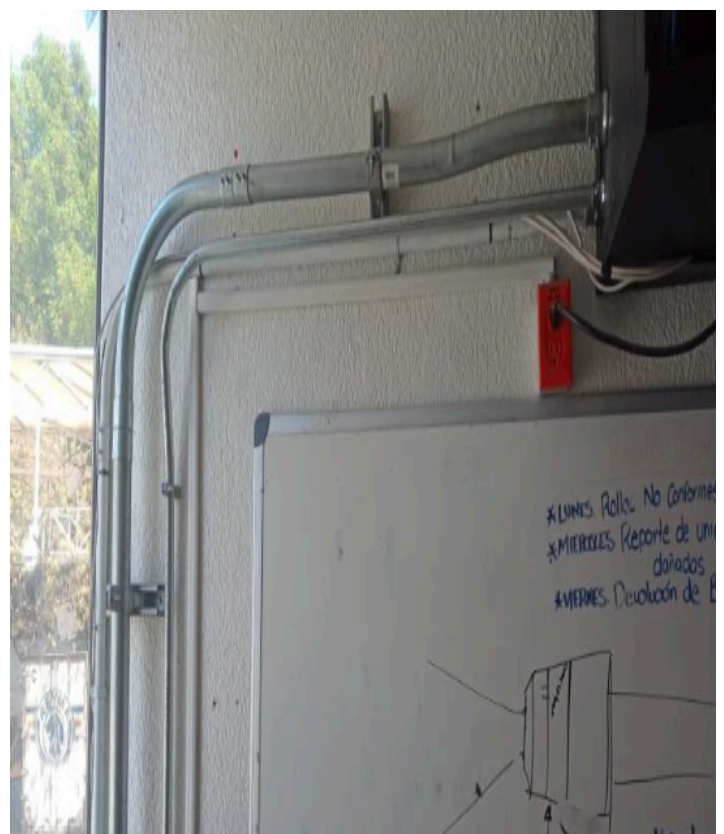
Por estos tubos pasan los cables de red hacia el gabinete y sirven para que no se dañen los cables de red y de los servicios especiales
