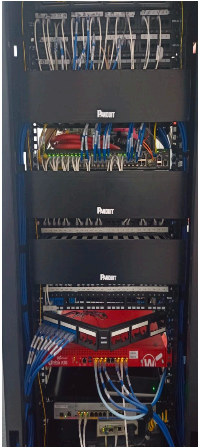
Aquí se puede apreciar finalmente como quedo el rack principal en el cuarto de servidores con todos los nodos de red principales y los servicios especiales
