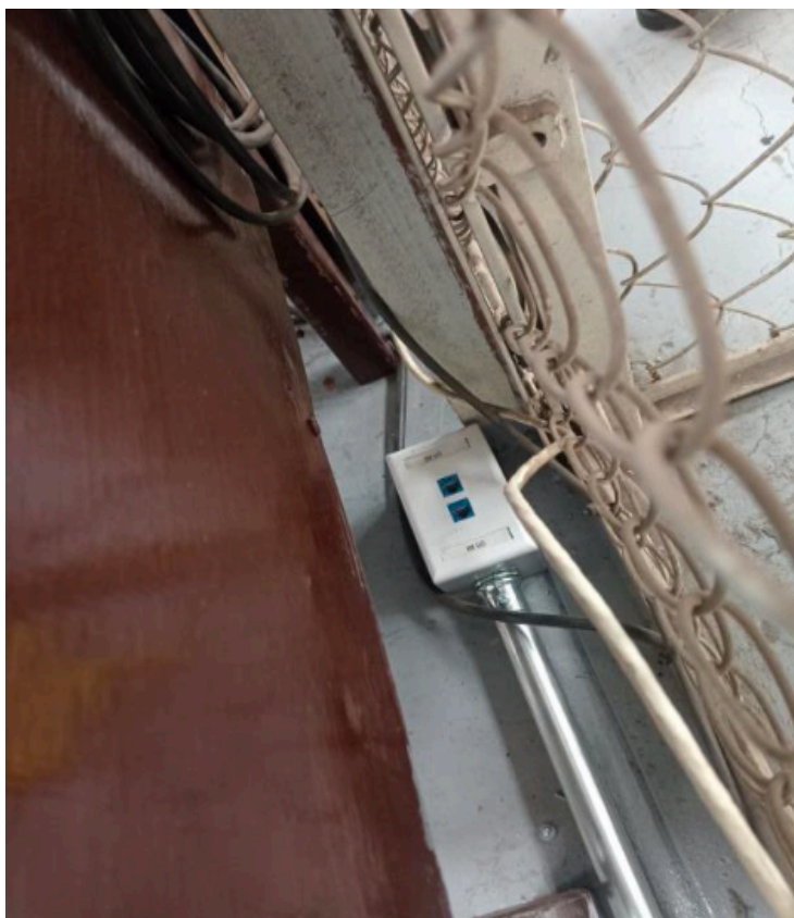
Aquí el cliente solicito algunas placas con 2 conectores uno de red y otro de datos finalmente quedaron así
