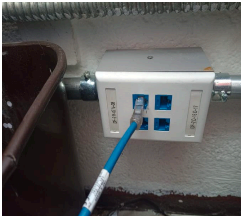
Aquí el cliente solicitó que algunas placas fueran de 4 puertos las cuales 2 son de voz y 2 de datos como se puede ver en la foto
