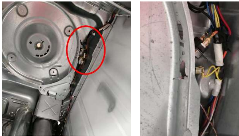
Figura 3.35. Sistema de control de calor y seguridad de la secadora de ropa deshabilitados
