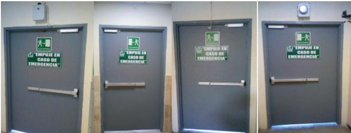
Figura 5. Señales de salida de emergencia.
