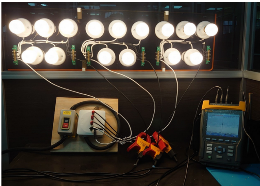
Figura 6.1: Medición de corrientes trifásicas en la red de pruebas con el Fluke 434.
