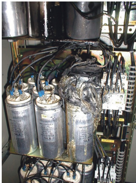
Figura 1.2: Explosión de banco de capacitores por presencia de armónicos.
