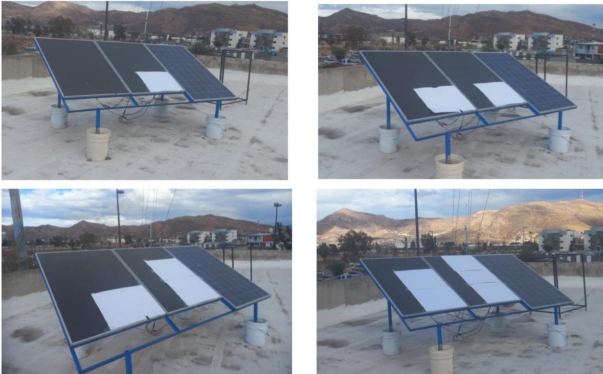
Figura 5.1. Simulación de fallas en los paneles fotovoltaicos.
