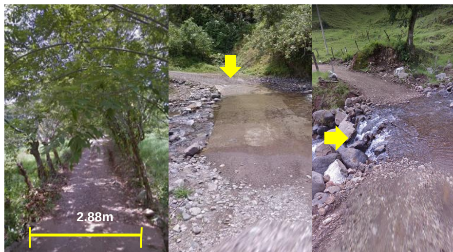
Figura 27. Carreteras sin Infraestructura.
