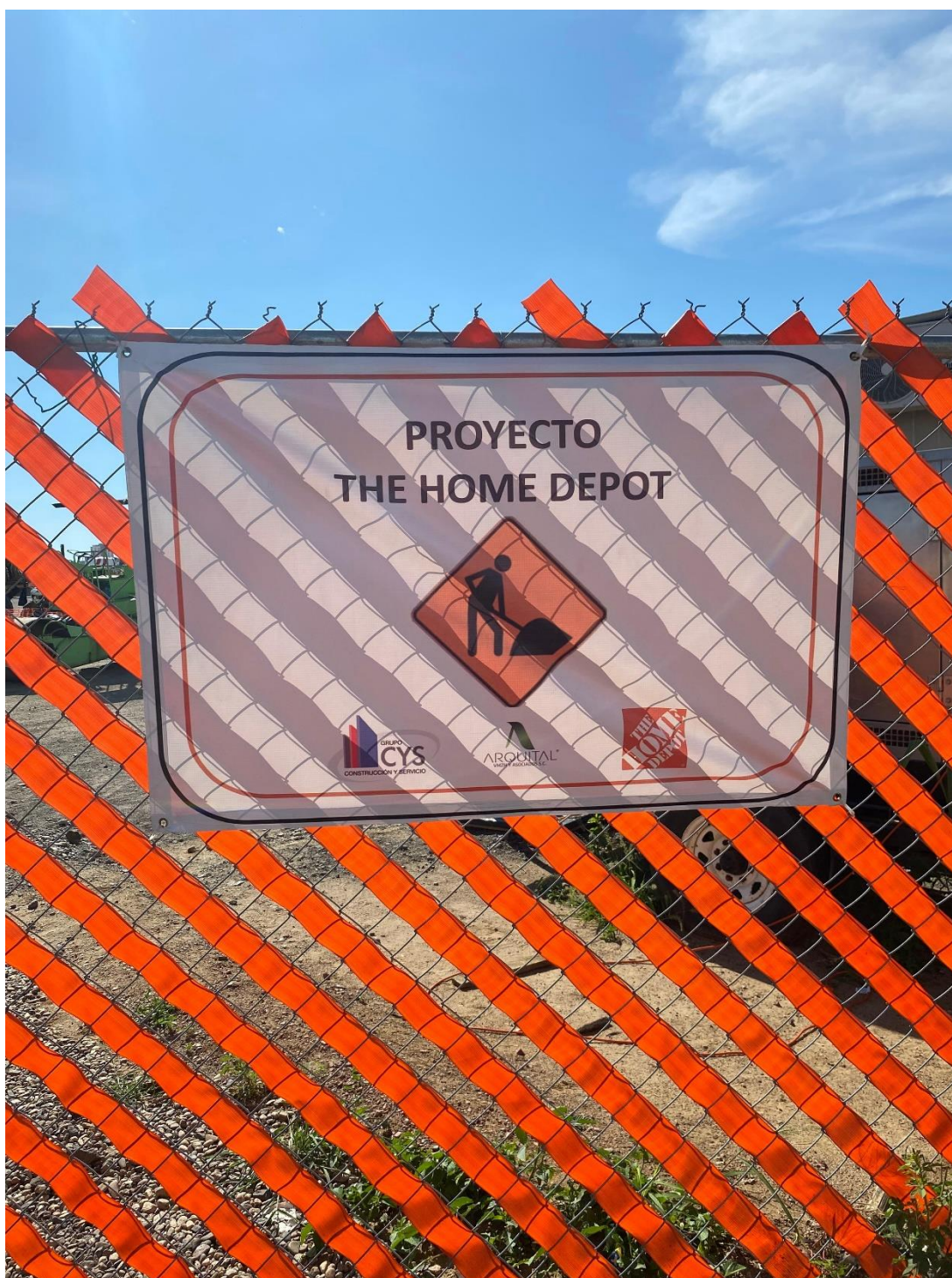
Figura 26 Cartelón de identificación Home Depot
