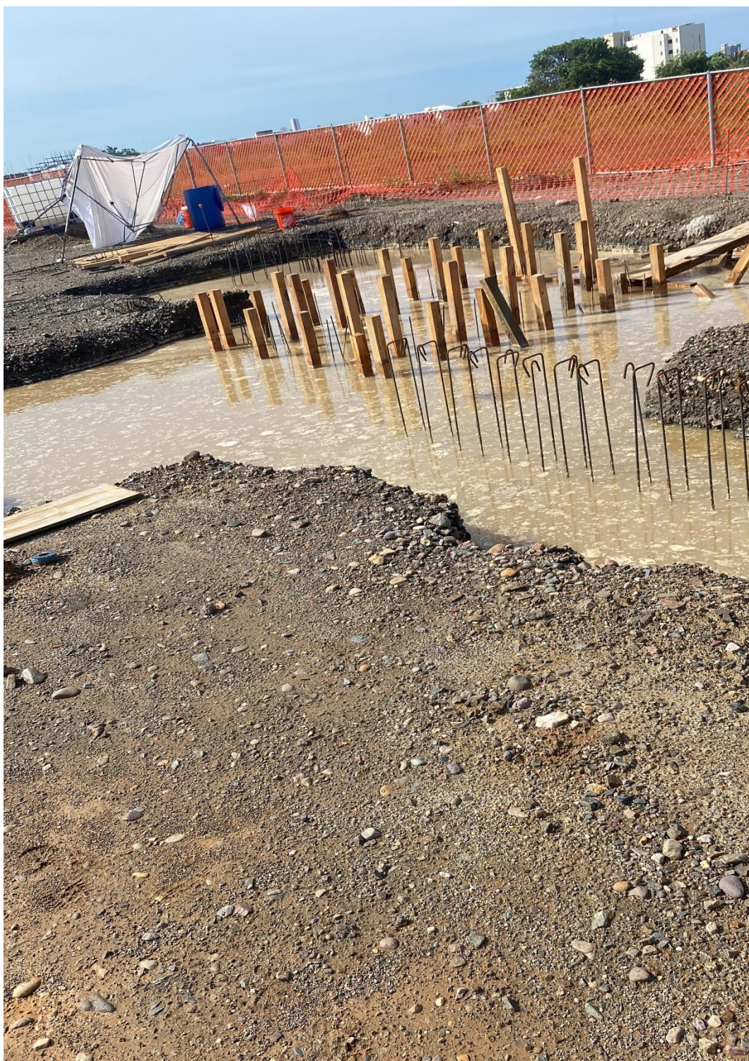
Figura 21 Problemas en construcción por estancamiento.
