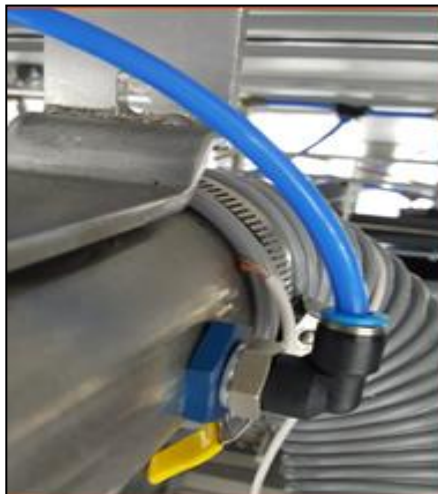
Conexión del manómetro
