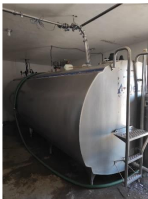
Figura 4.4 Tanque donde se almacena el liquido
