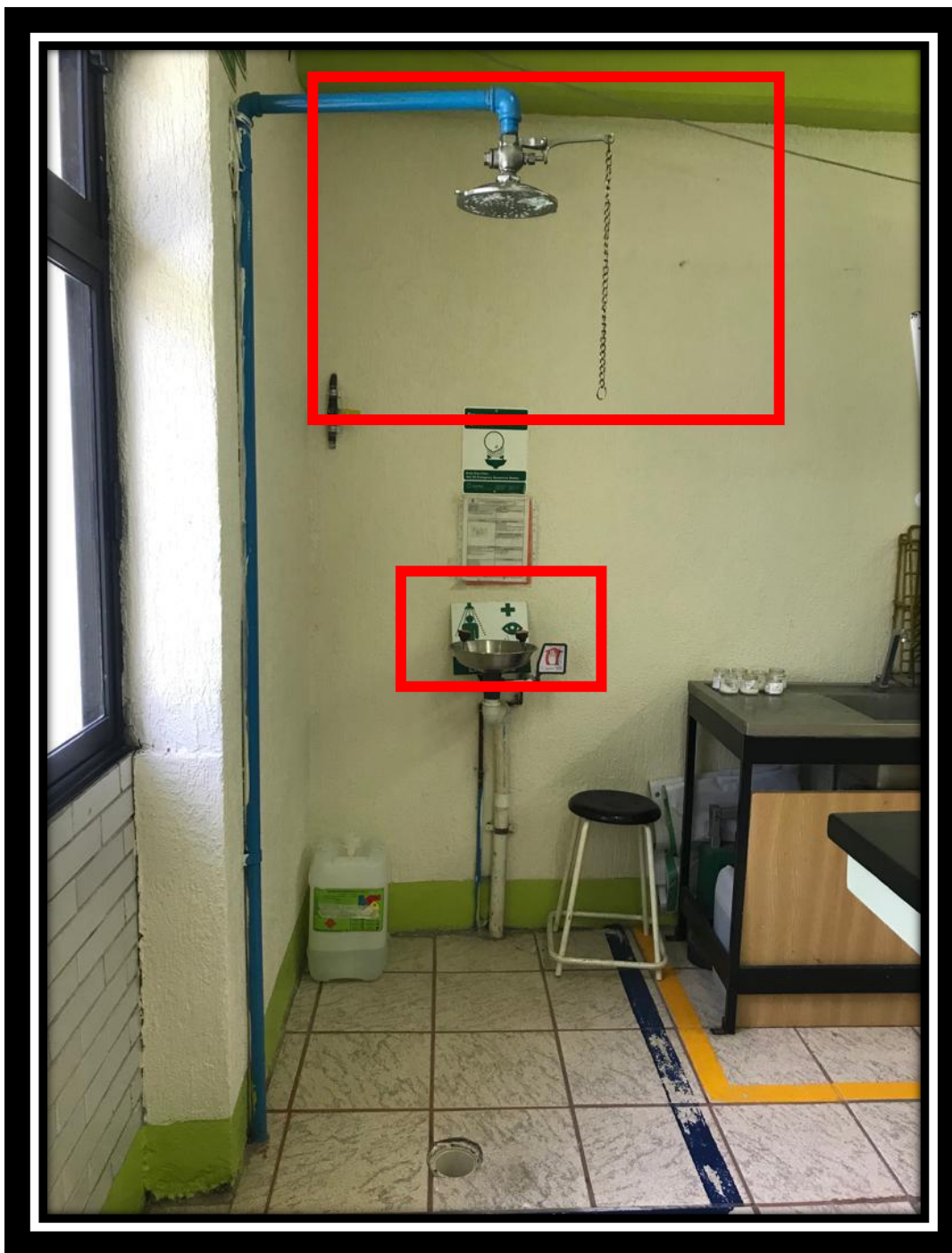
Figura 5 Fotografía del área de equipo de emergencia (regadera y lava ojos). (Elaboración propia)
