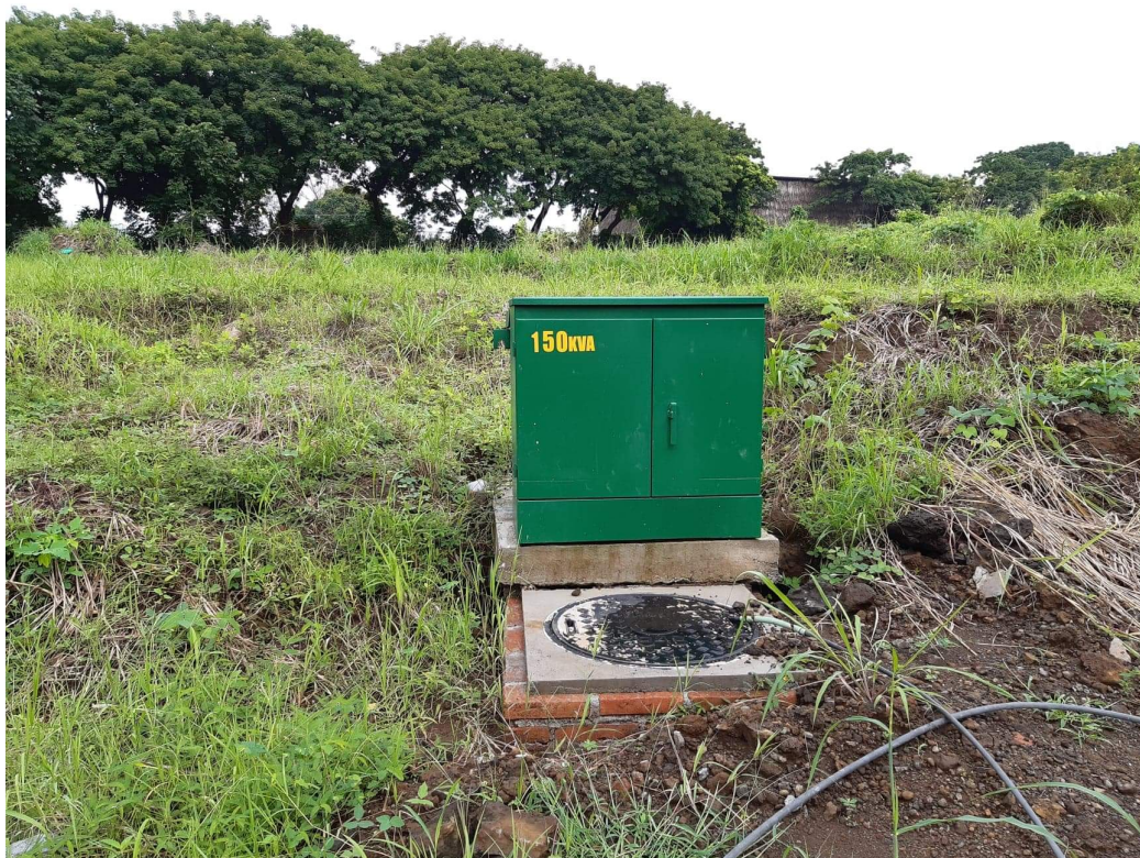
Figura 3.2: Subestación 3 del ITSSAT
