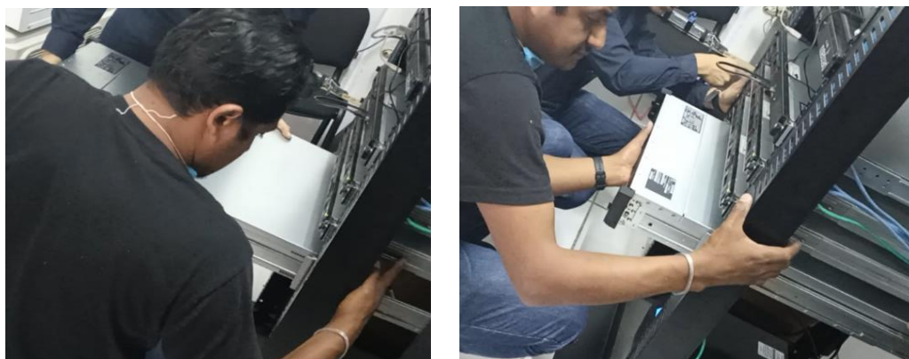
Ilustración 63 Prueba de deslizamiento del servidor en el rack
