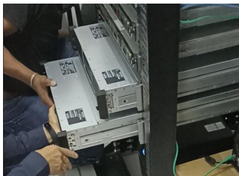
Ilustración 64 Instalación de los servidores en el rack
