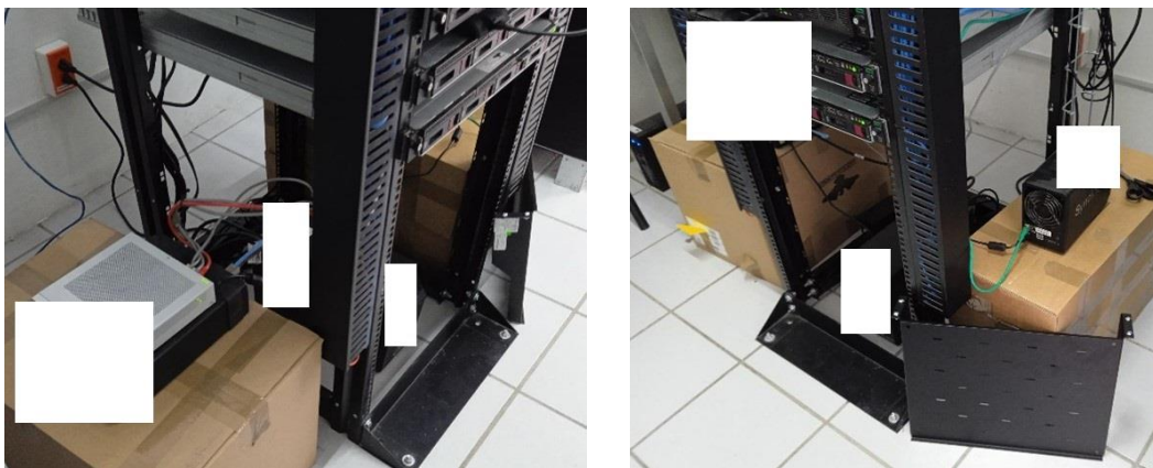
Ilustración 59 Acomodo para integración de servidores en el site
