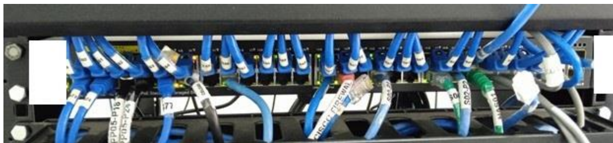
Ilustración 76 Cableado del rack identificado y etiquetado
