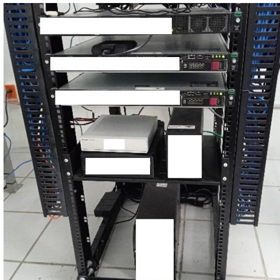
Ilustración 58 Rack del site
