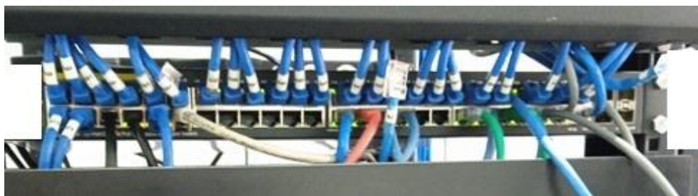
Ilustración 74 Cables sin identificación
