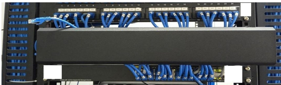
Ilustración 73 Cableado del Patch Panel al Switch
