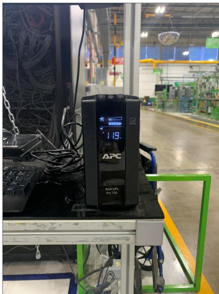
Figura 48 Verificación funcional de UPS.
