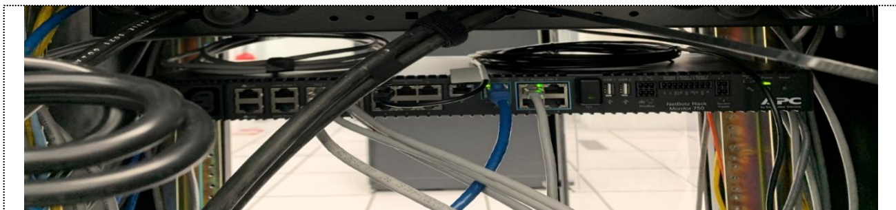
Figura 29 Segundo NetBotz 750 (Inferior del rack del servidor).
