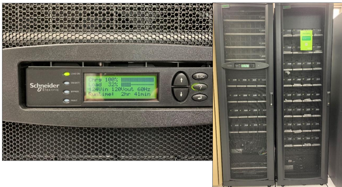
Figura 46 Verificación de funcional banco de baterías del centro de datos.
