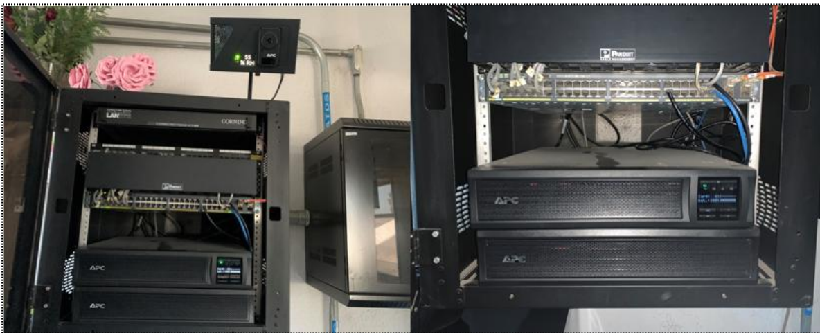
Figura 37 IDF-1 Instalación de NetBotz 755 y UPS Vigilancia (surveillance).
