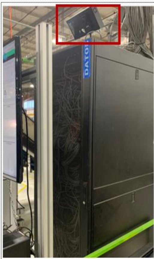
Figura 43 IDF-6 Instalación de NetBotz 755 QOM2 BRK.
