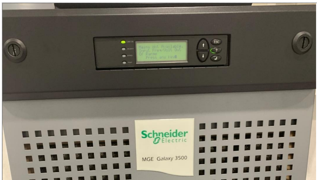
Figura 47 Verificación funcional del banco de energía en sala (Mezzanine).
