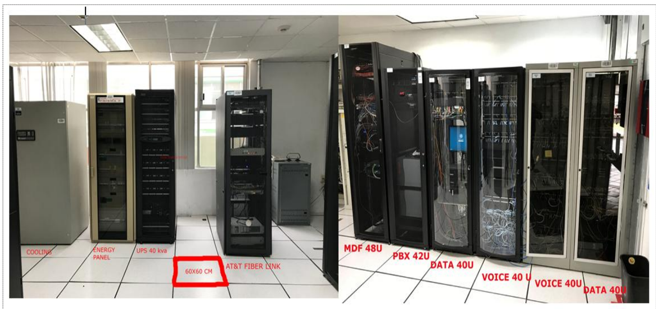
Figura 8 Racks internos del Centro de Datos.
