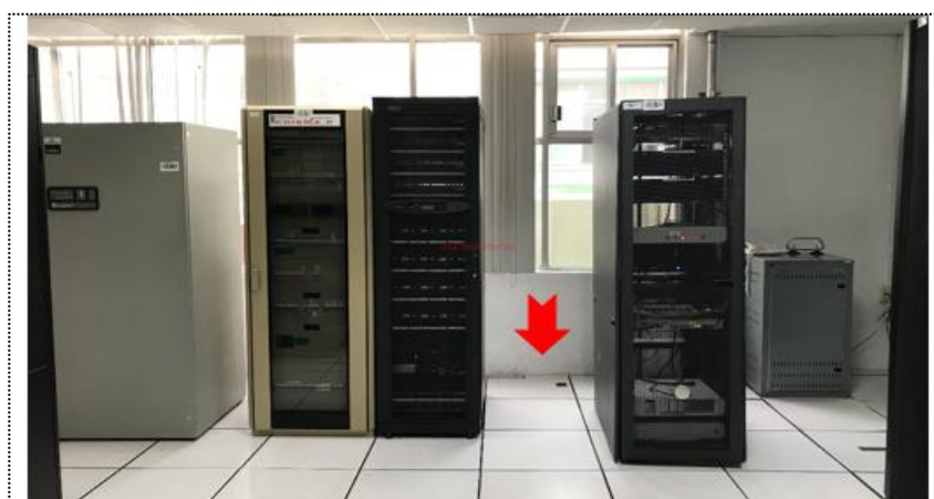
Figura 34 Espacio designado al banco de energía interno del centro de datos (ANTES).
