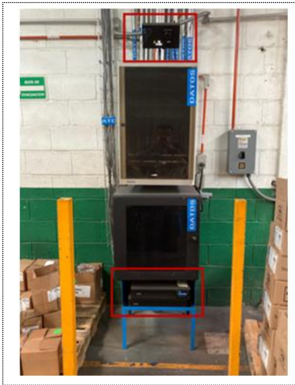
Figura 39 IDF-2 Instalación de NetBotz 755 y UPS Embarques (shipping).
