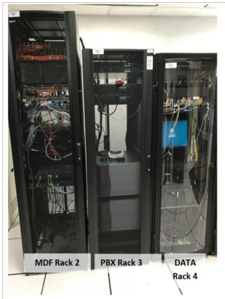
Figura 11 RACKS primarios rack 2, rack 3 rack 4 del centro de datos.
