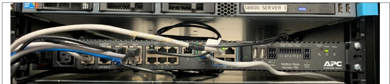
Figura 28 Primer NetBotz 750 (Superior del rack del servidor).
