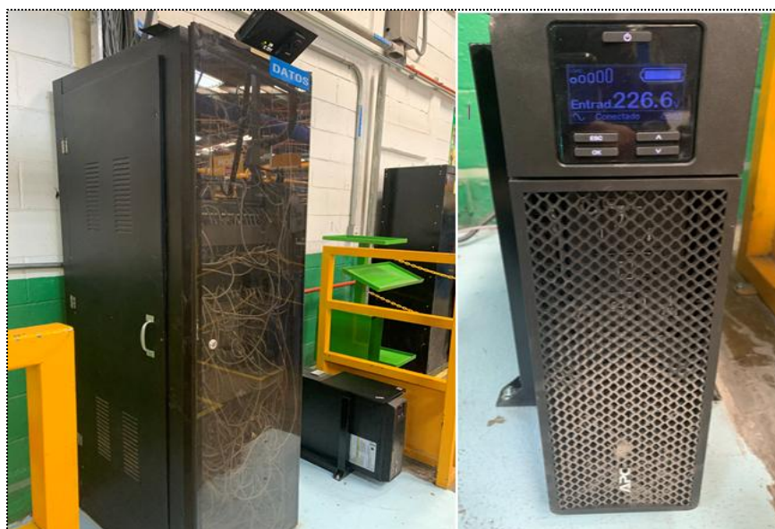
Figura 41 IDF-5 Instalación de NetBotz 755 y UPS Mantenimiento (Maintenance).
